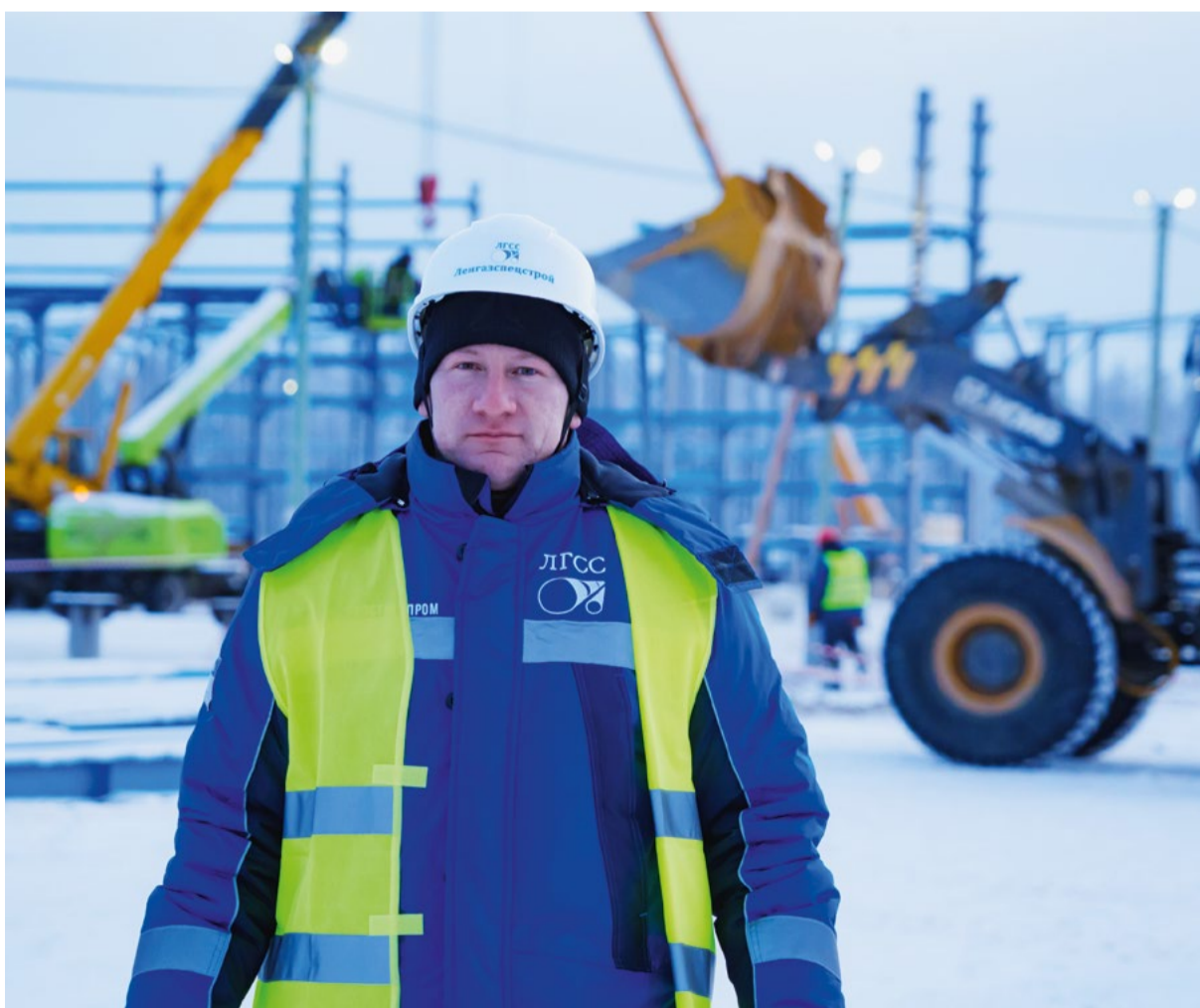
▲ На строительстве объектов Ковыктинского месторождения задействованы только профессионалы. На площадке строительства УКПГ-45 они выполняют работы по монтажу и обварке металлоконструкций под технологические коммуникации
