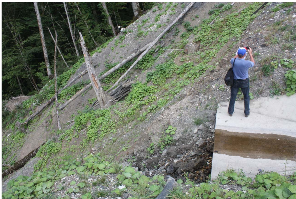
Фото 10. Склон между СТ-11 и СТ-13, СТ-13/1 поражен эрозионно-оползневыми процессами и требует мероприятий по защите от дальнейшего разрушения
