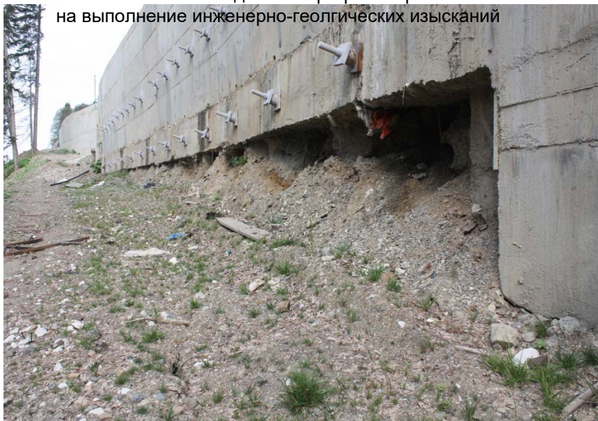
Фото 26. Оголенные фундаменты СТ-75, грунт вымывается и осыпается между сваями
