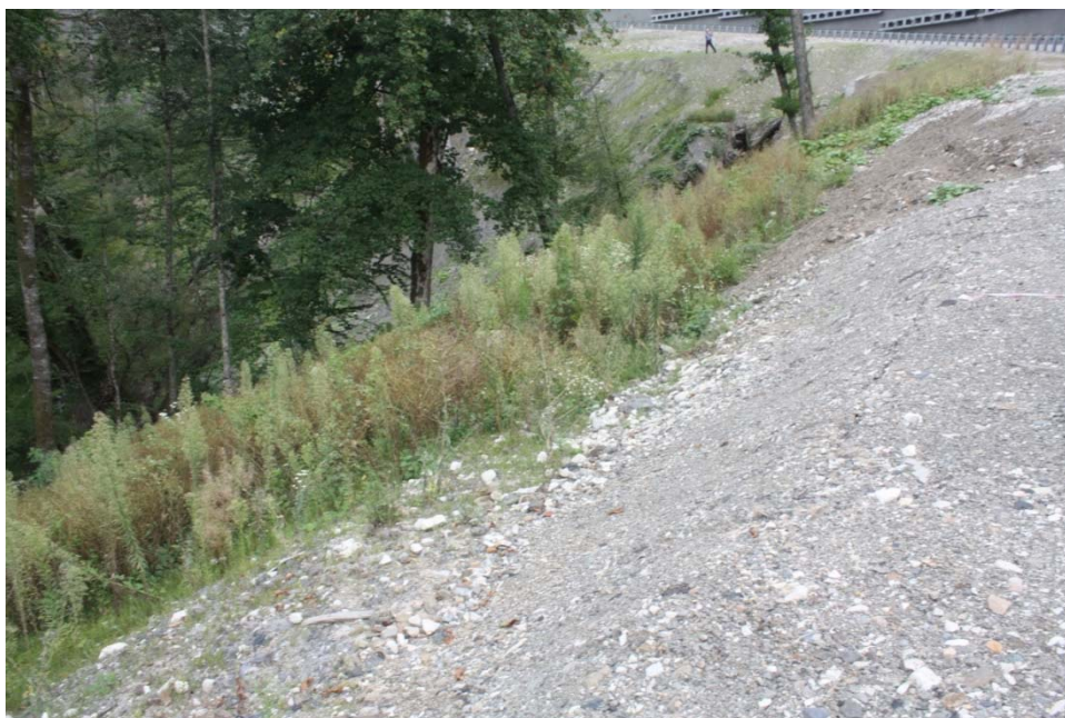
Фото 6. Общий вид на склон ниже СТ-10 в сторону СТ-6 – наблюдаются трещины отрыва в насыпном грунте, склон порос травой, но деревья наклонены вниз по склону
