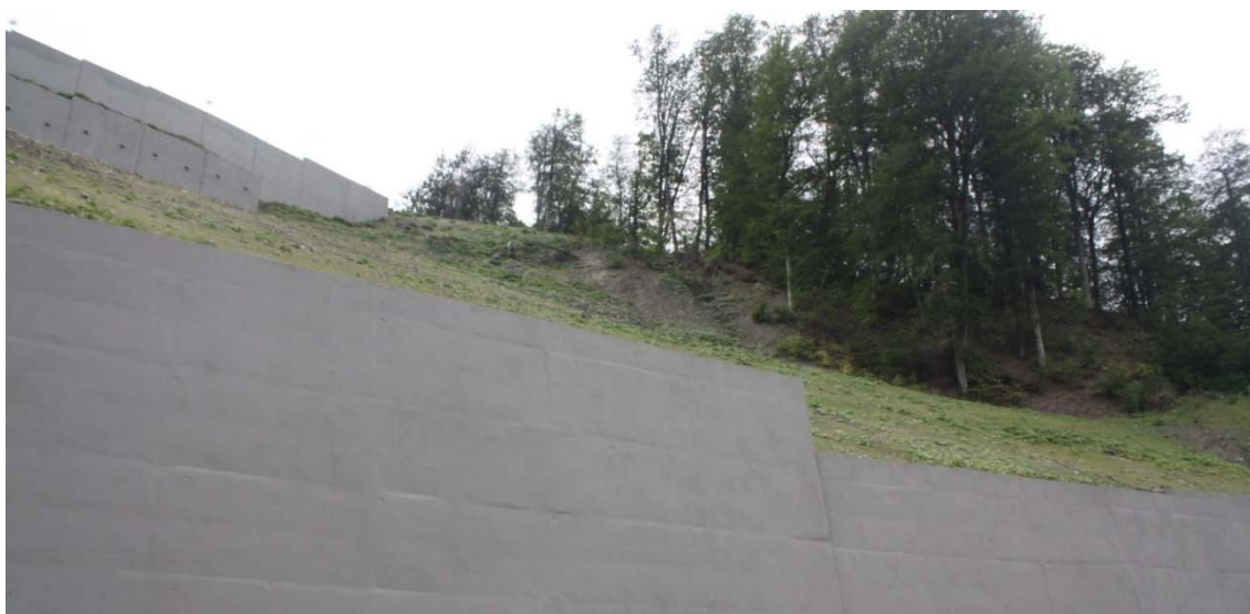
Фото 11. Склон выше СТ-10 до СТ-15, в подрезках оползневые смещения без растительности, с эрозионным поражением от поверхностных водотоков
