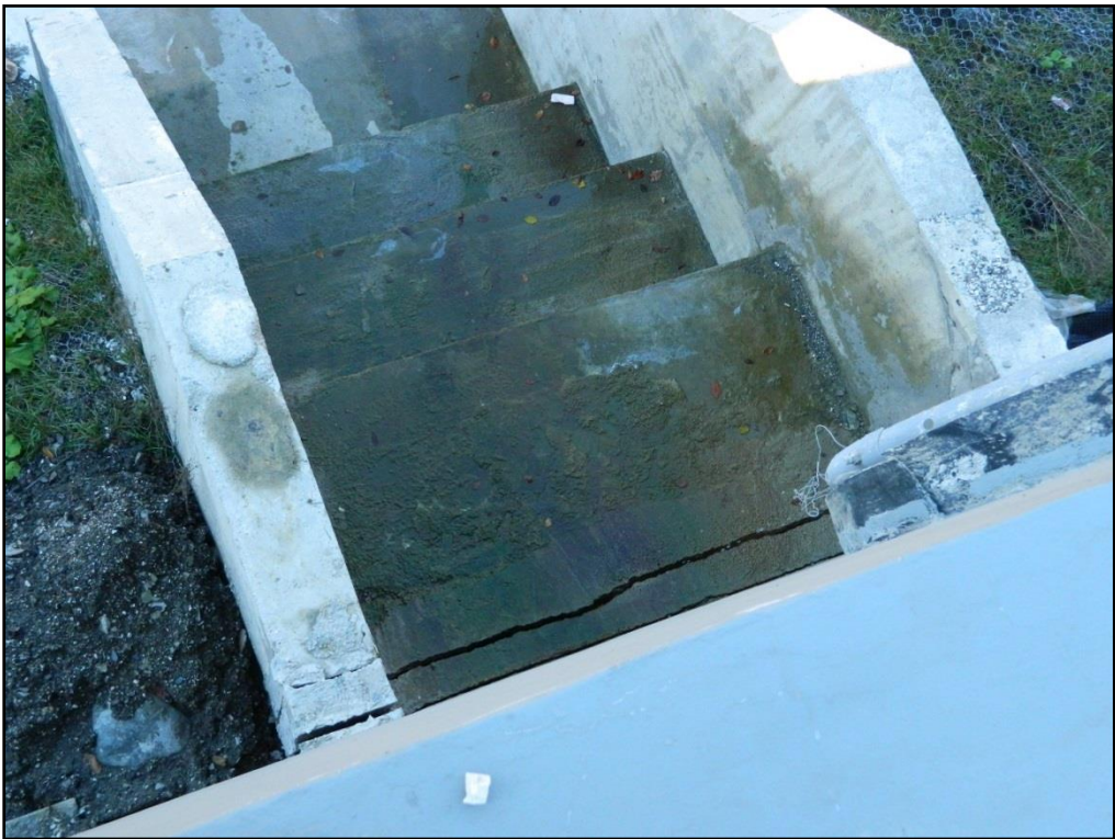
Рисунок 7 - Трещина в водопропускном сооружении. Т.н. 17
