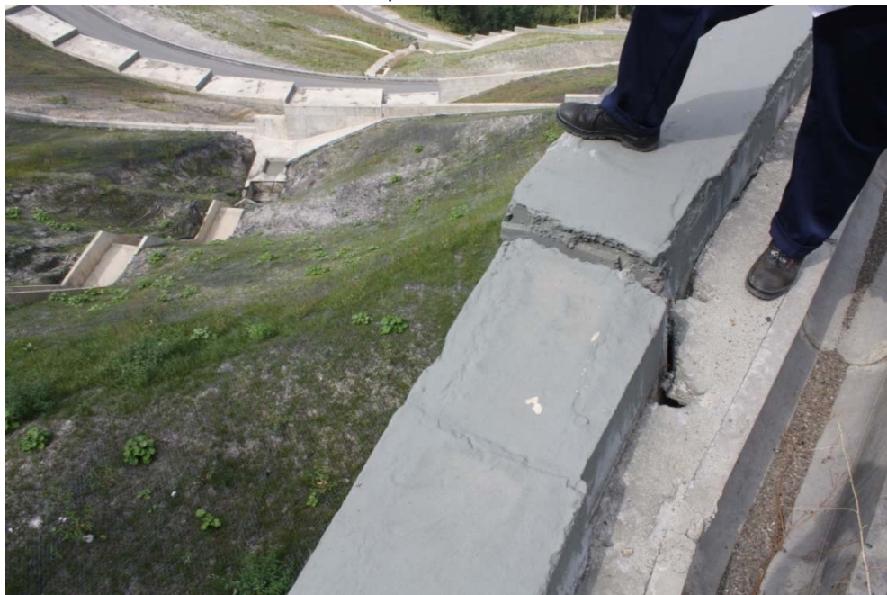
Фото 14. Трещина между блоками СТ-20/1
