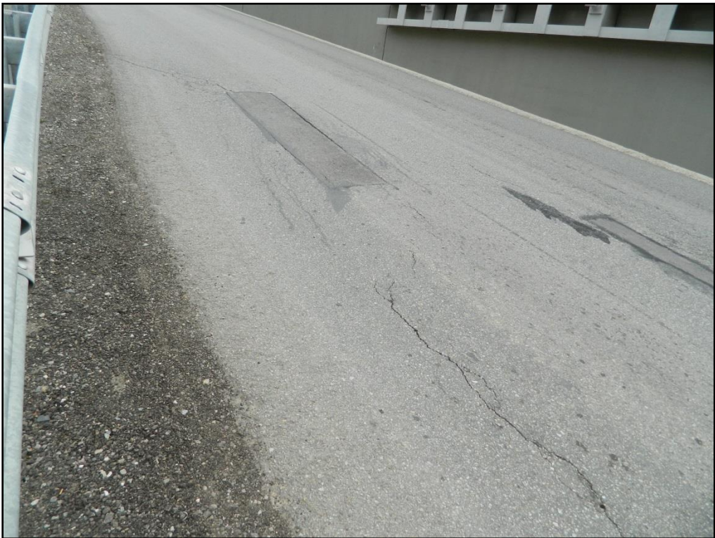
Рисунок 6 - Трещины отрыва в асфальте. Т.н. 648
