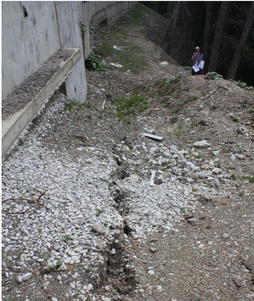
Фото 23. Трещины в насыпном грунте вдоль всей подпорной стены СТ-75, деревья наклонены
