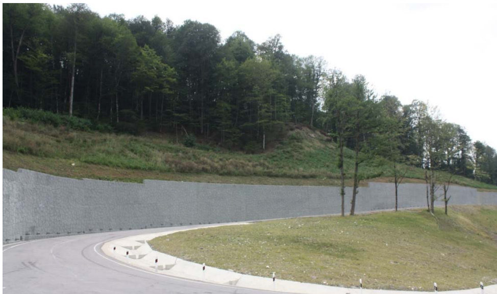
Фото 16. Выше СТ-1(VIP) склон подрезан без закрепления
