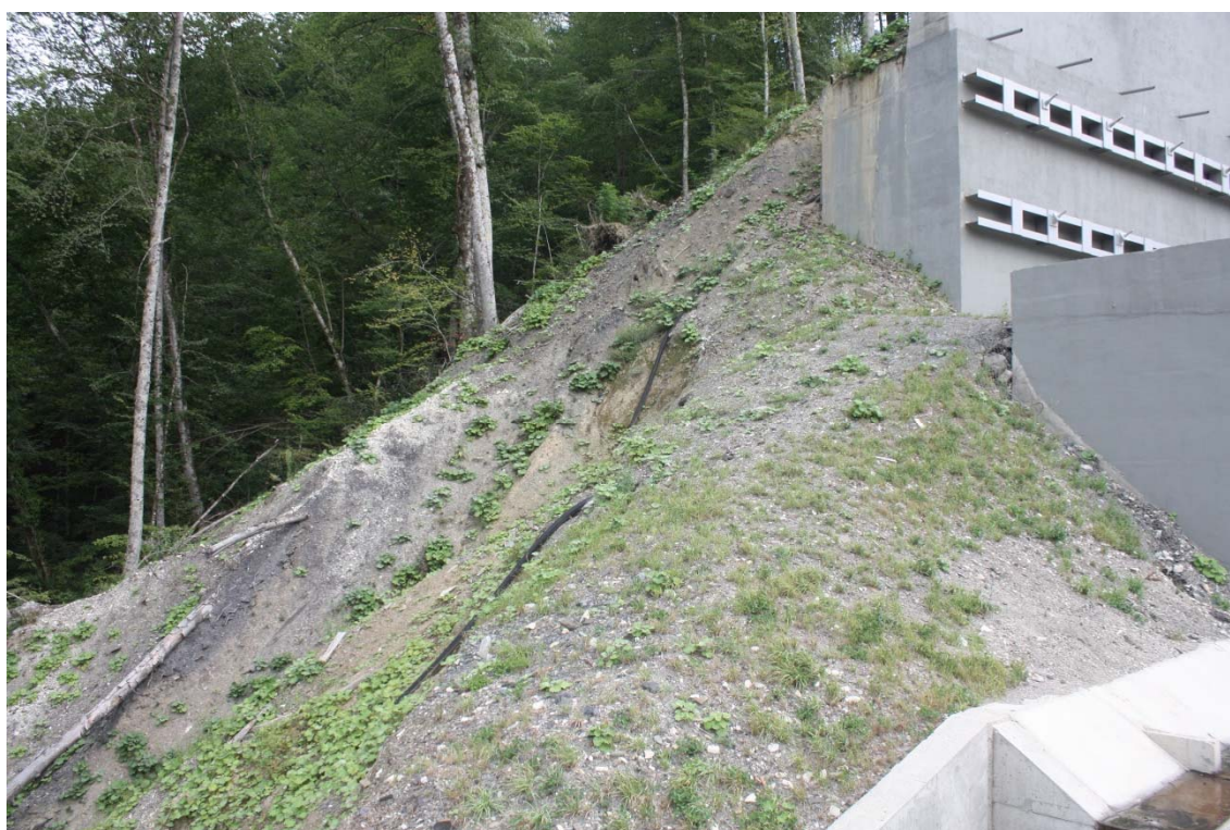
Фото 9. Склон ниже СТ-13, СТ-13/1
