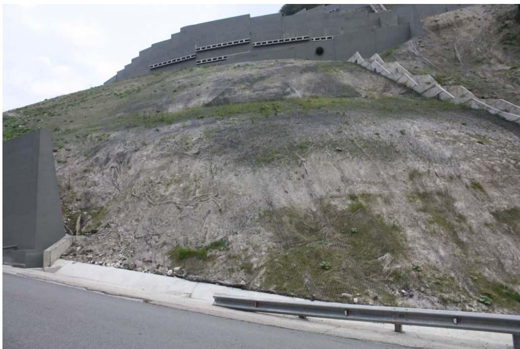
Фото 2. Сетка не держит массы грунта, происходит его сползание
