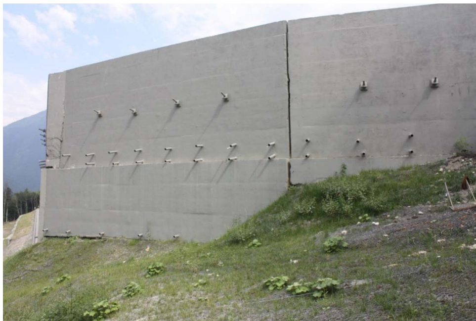
Фото 15. Трещины в СТ-20/1, расхождение между блоками и по водоотводному лотку указывают на неустойчивость склона
