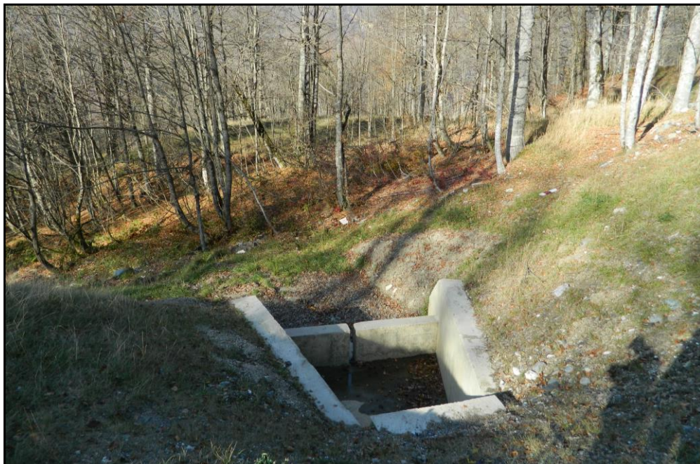
Фото 121. Водопропускные сооружения. Развитие эрозионных процессов. Т.Н.495.
