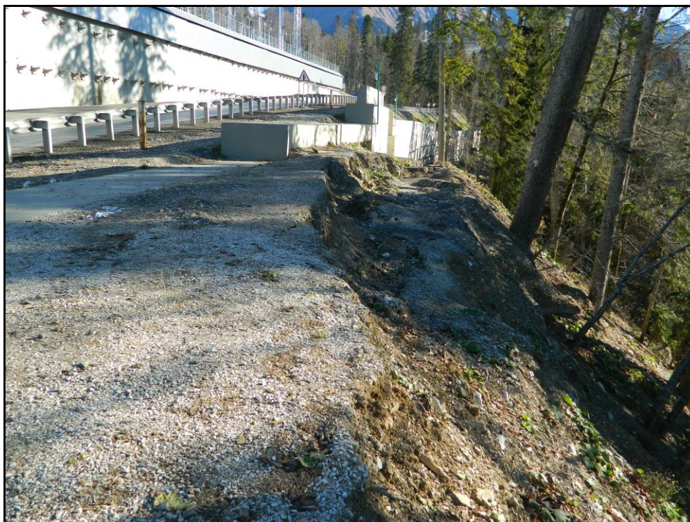
Фото 44. Трещины отрыва. Т.Н.51.
