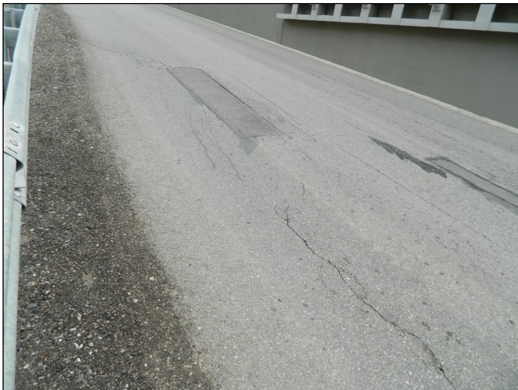
Фото 144. Трещины отрыва. Т.Н. 648.
