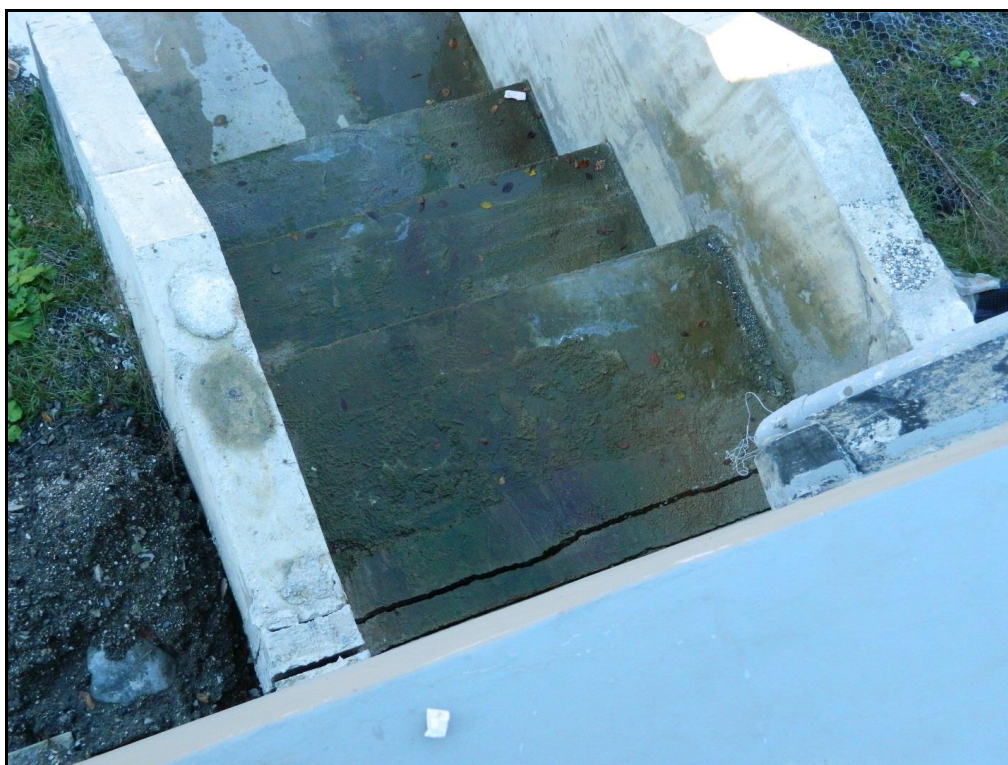
Фото 15. Трещина в водопропускном сооружении. Т.Н.17.
