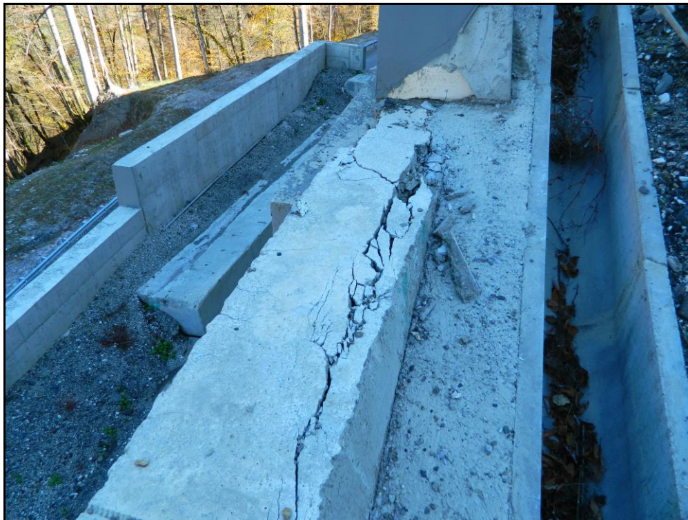
Фото 93. Трещины в стене в верхней части. Т.Н.267.
