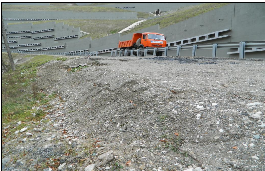
Фото 143. Трещины отрыва. Т.Н. 648.
