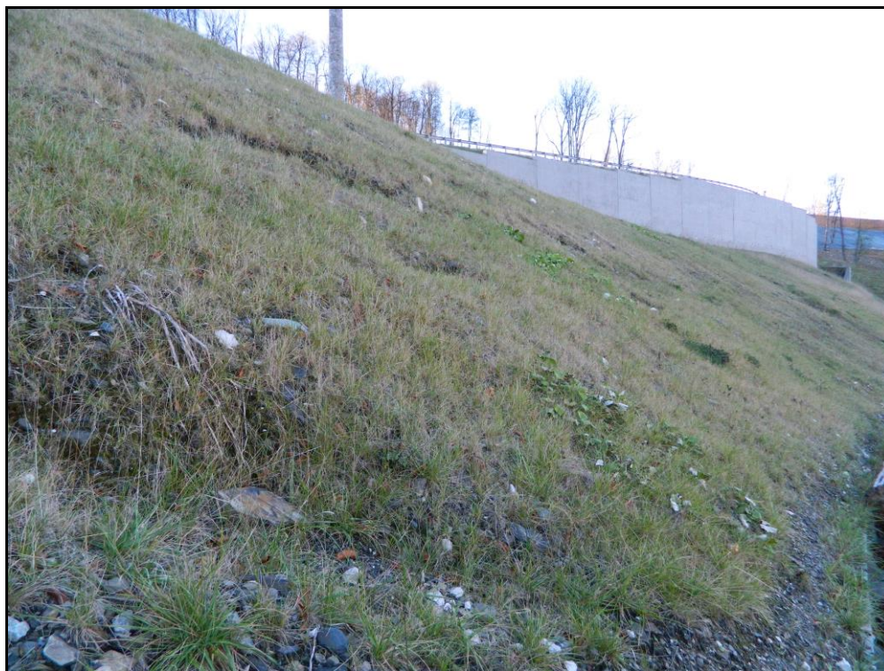
Фото 84. Трещины срыва. Т.Н.209.
