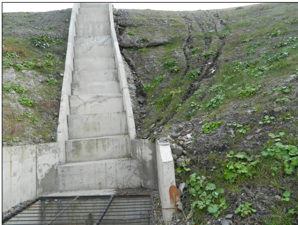
Фото 141. Развитие эрозионных и оползневых процессов. Т.Н. 630.
