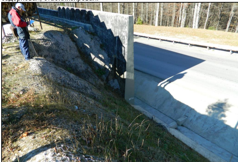
Фото 72. Следы эрозионных процессов. Т.Н.124.
