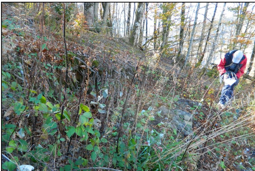
Фото 2. Стенка отрыва древнего оползня. Т.Н. 2.
