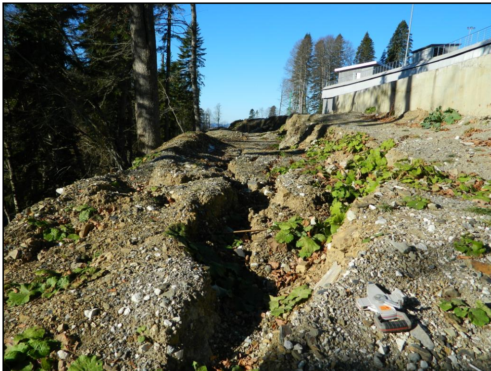
Фото 43. Трещина отрыва. Т.Н.50.
