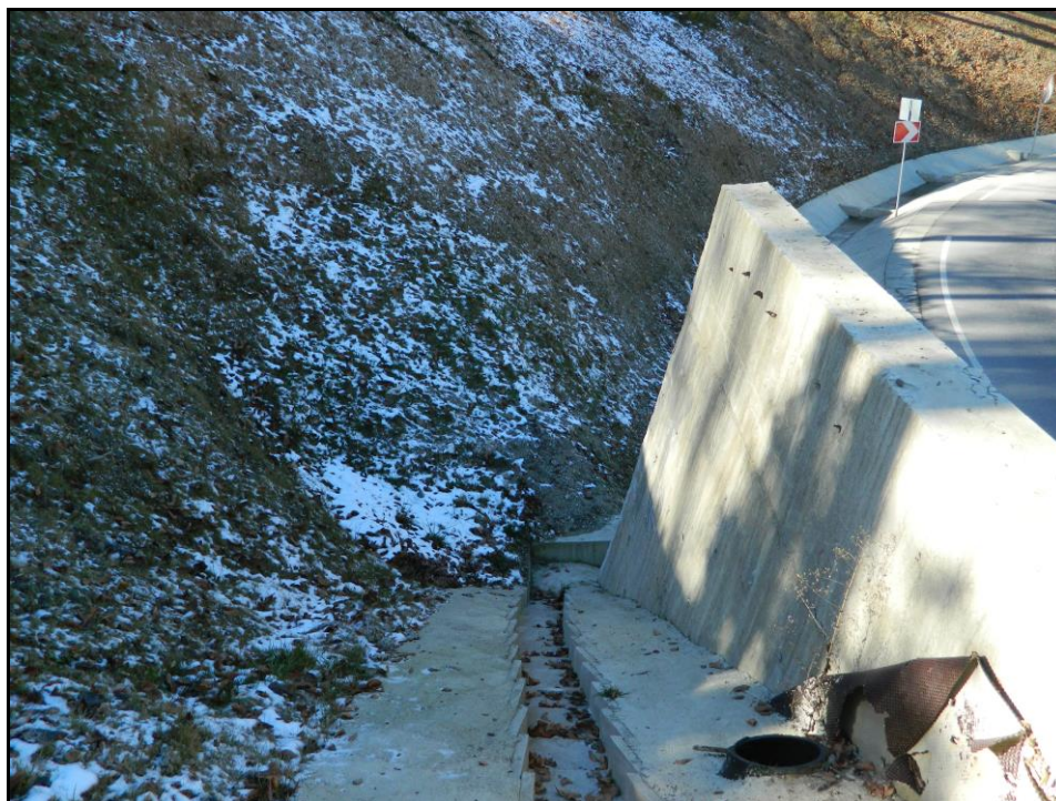
Фото 66. Следы эрозионных процессов. Т.Н.99.
