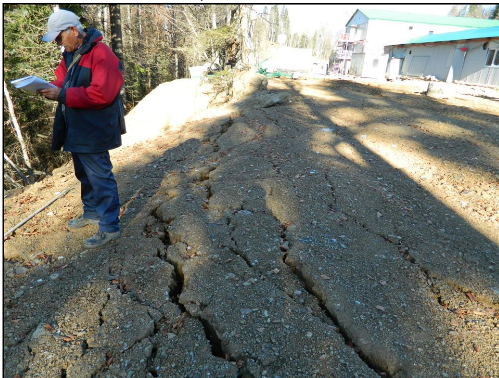
Фото 49. Трещины отрыва. Т.Н.56.
