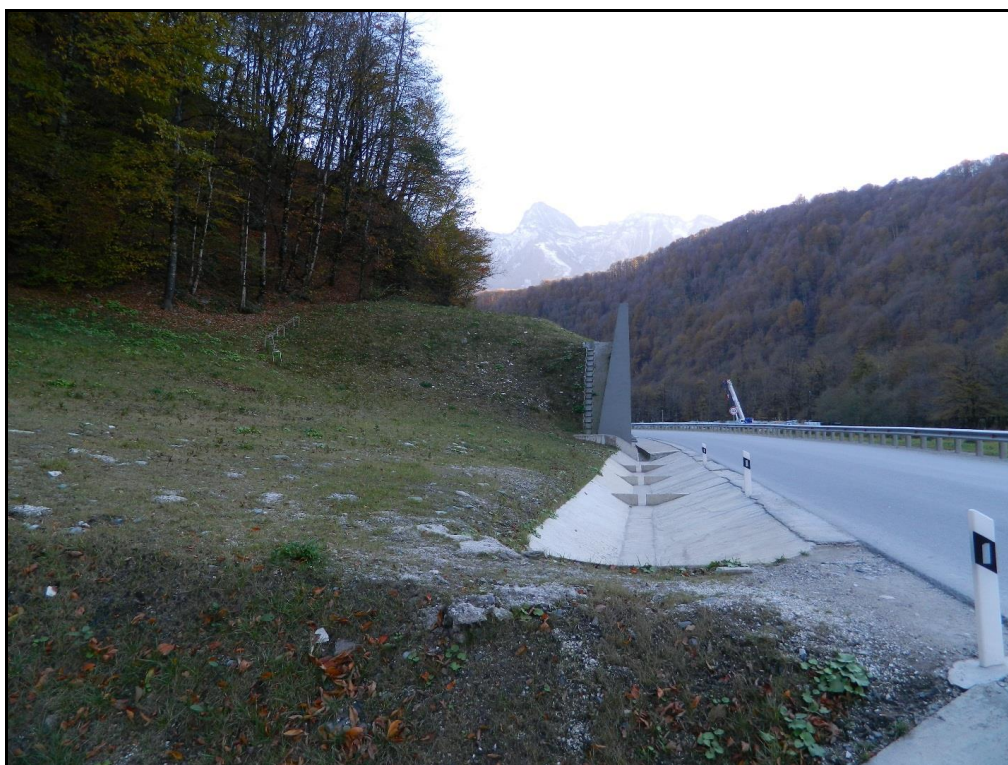
Фото 33. Оползнеопасный склон. Т.Н.38.
