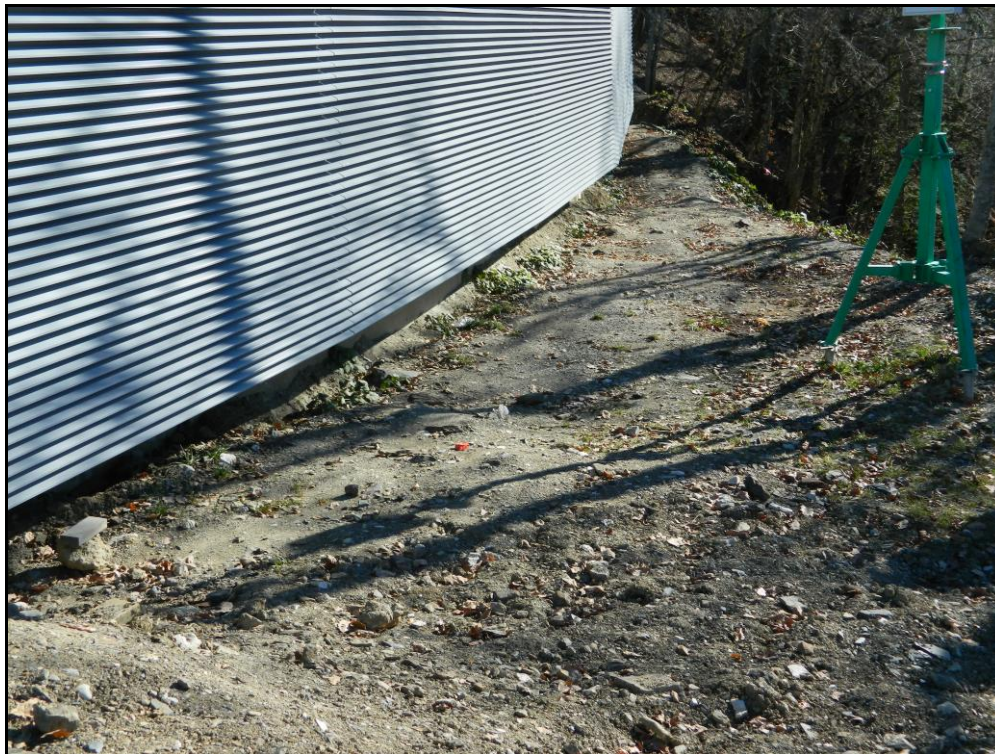
Фото 57. Проседание грунта. Т.Н.71.
