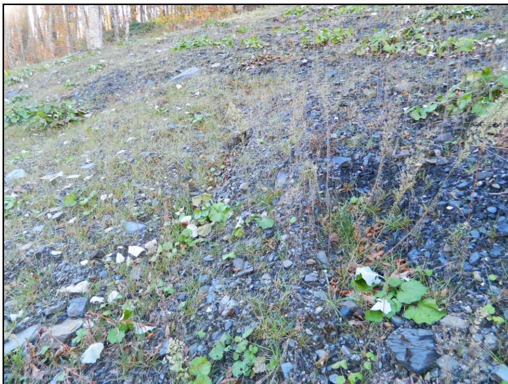
Фото 88. Оползание склона. Т.Н.239.
