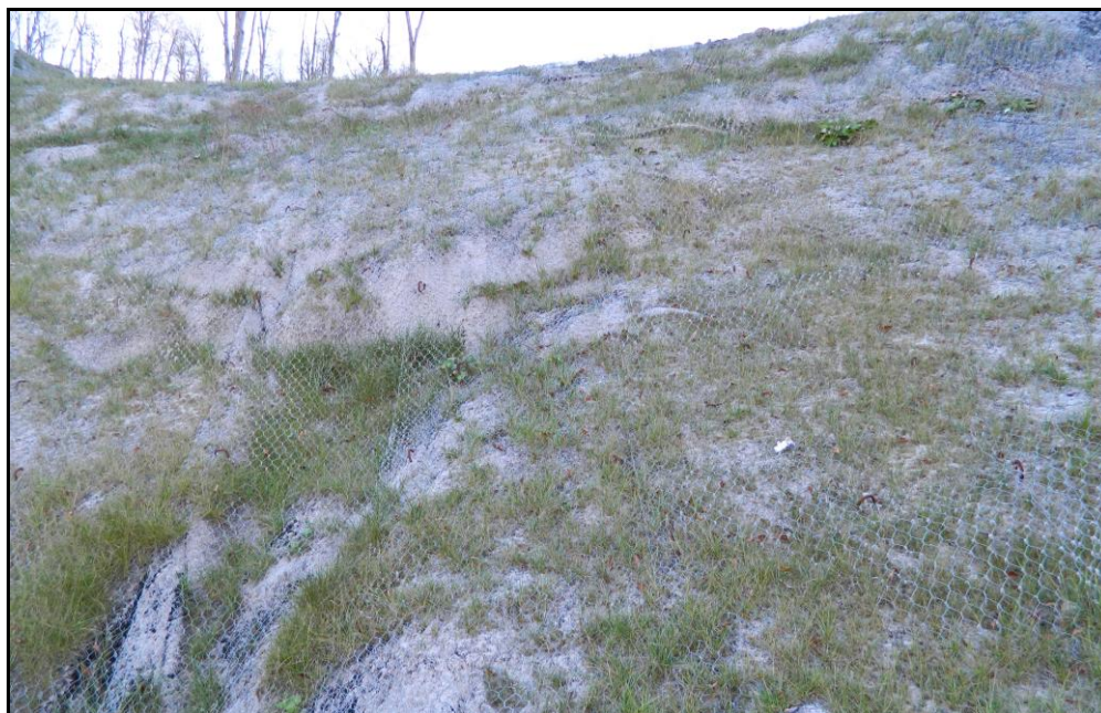
Фото 85. Следы эрозии осыпания, закрепленный склон. Т.Н.213.
