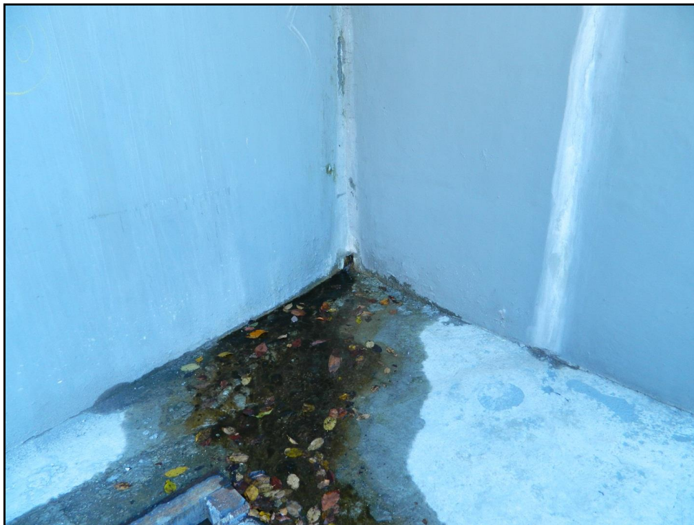
Фото 11. Высачивание воды в подпорной стенке. Т.Н. 12.
