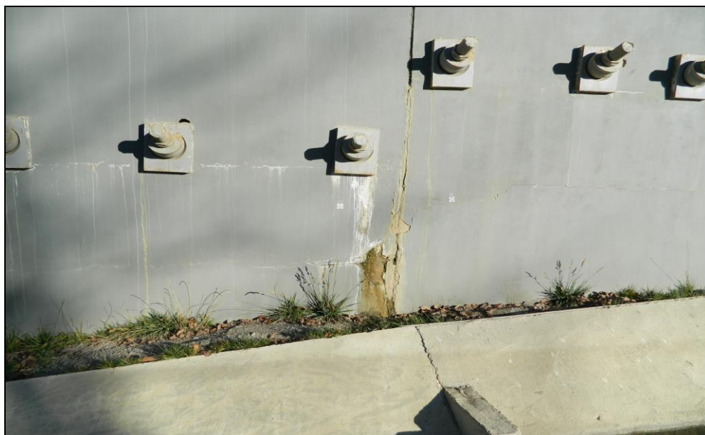
Фото 109. Просачивание воды между стыками подпорной стены. Т.Н.378.
