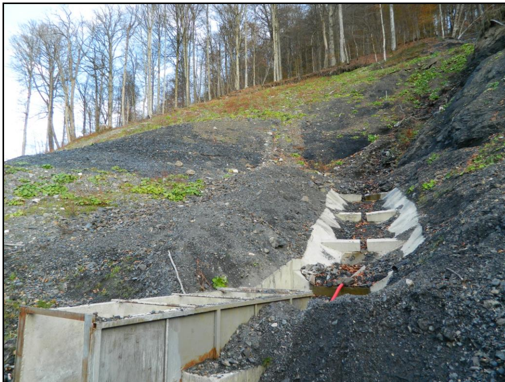
Фото 126. Водопропускные сооружения. Развитие обвально-осыпных процессов. Т.Н.554.
