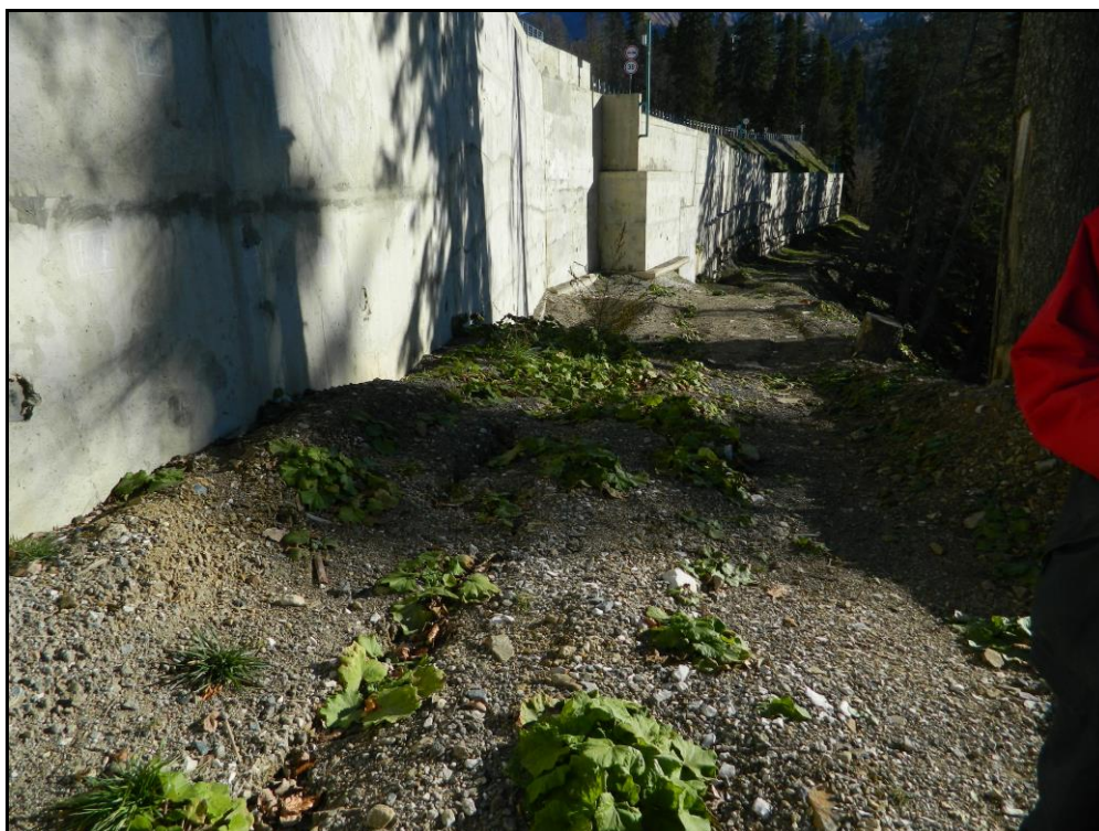
Фото 42. Трещина отрыва. Т.Н.49.
