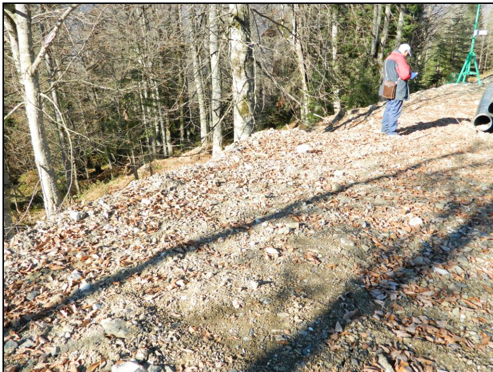
Фото 59. Трещины оседания в насыпи. Т.Н.75.
