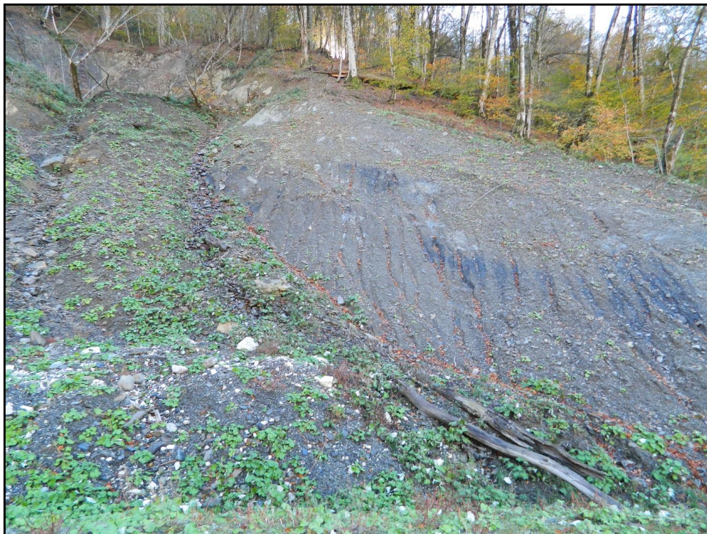
Фото 8. Следы эрозионных потоков. Т.Н. 9.
