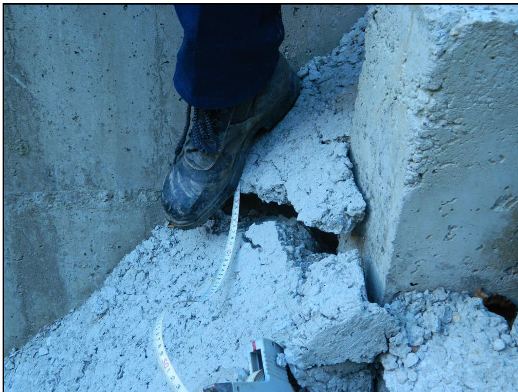
Фото 4. Трещина в стене. Т.Н. 5.
