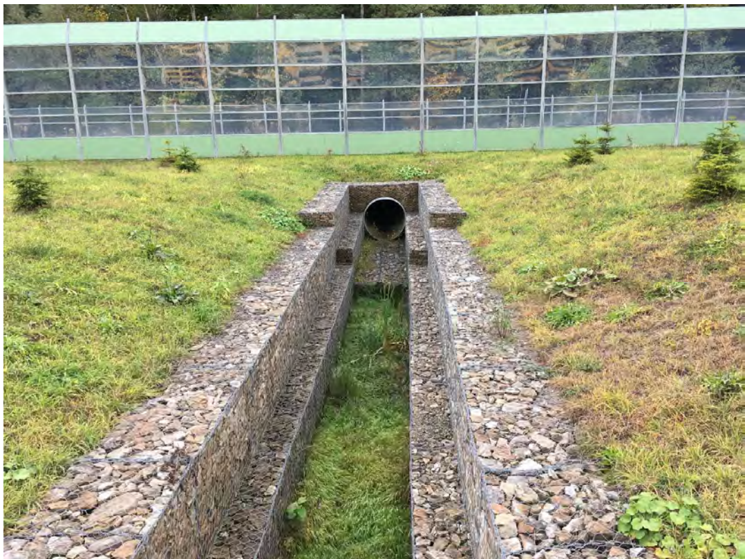
Рисунок 4.4.5 - Водовыпуск с подгорной части дороги ручья б/н №3
