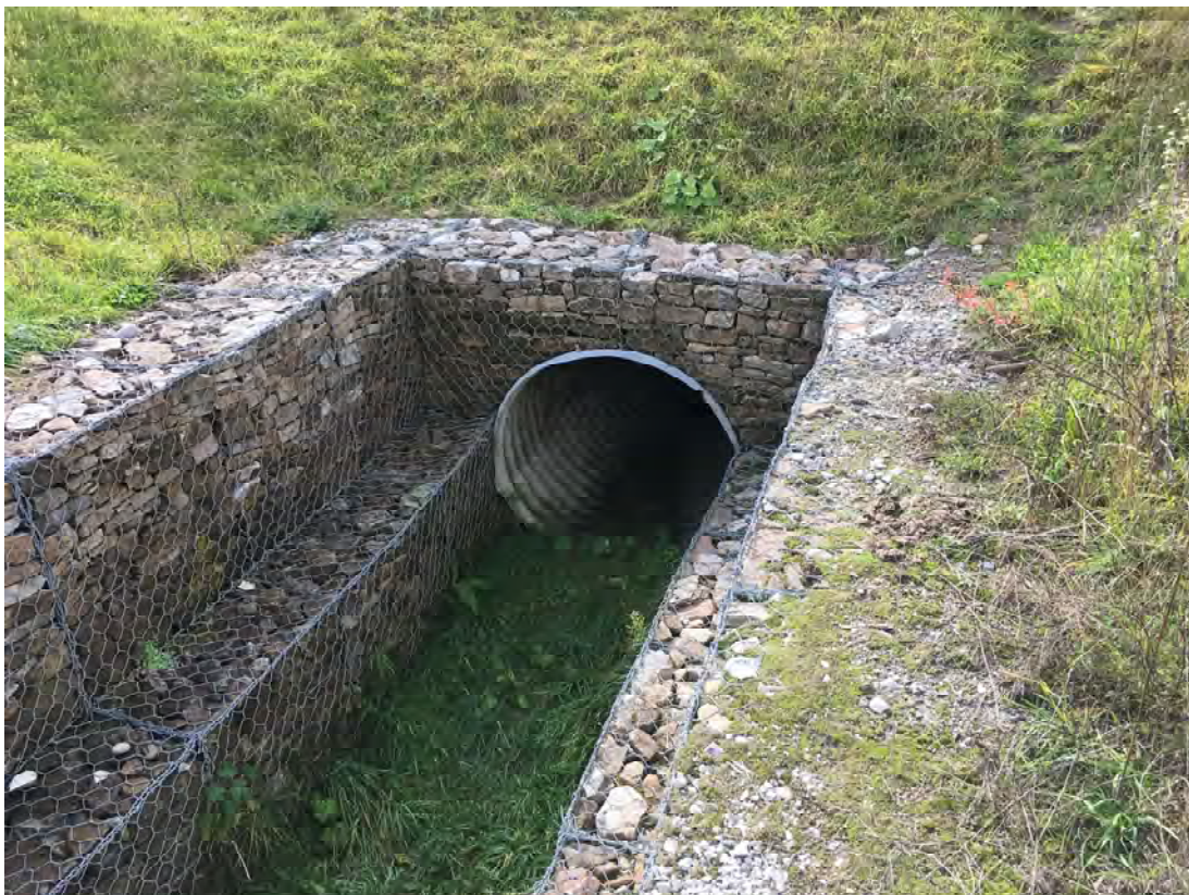
Рисунок 4.4.3 - Водовыпуск с подгорной части дороги ручья б/н №2
