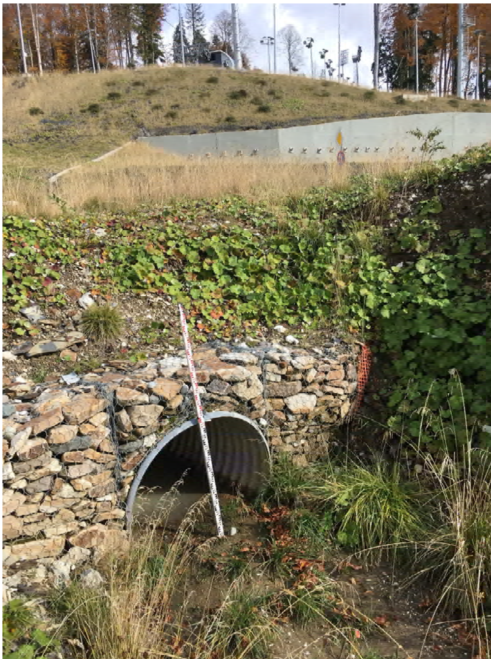
Рисунок 4.4.62 - Водовыпуск с подгорной части дороги, второй от дороги в створе №46 ручья б/н №30
