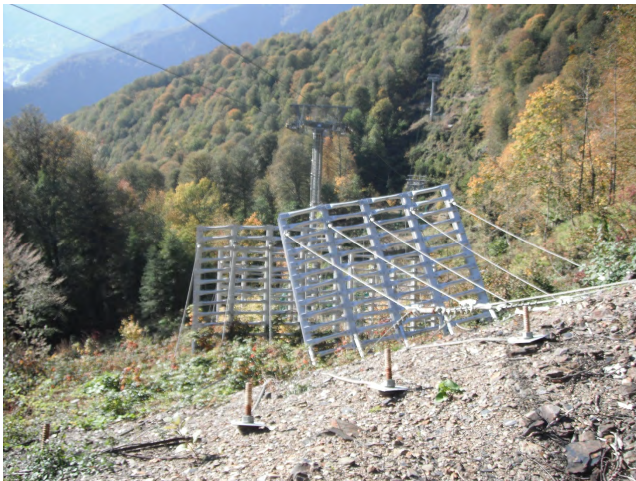
Рис. 6.74. 4 снегоудерживающих щит на направлении в сторону опоры канатной дороги.
