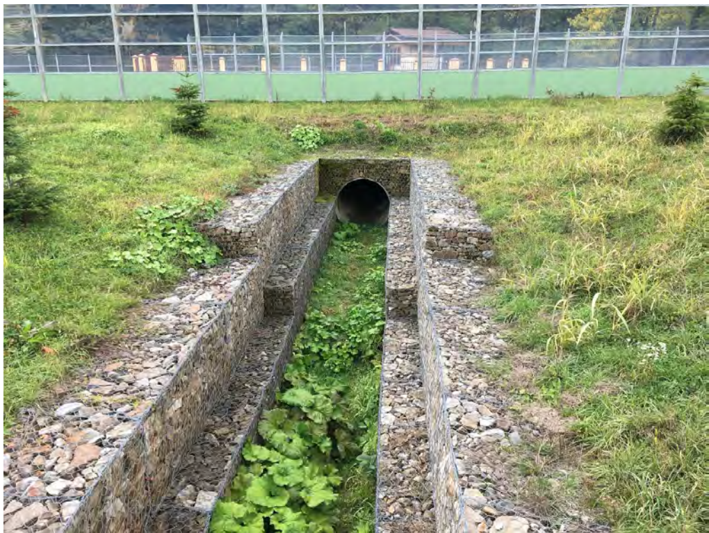
Рисунок 4.4.1 - Водовыпуск с подгорной части дороги Ручья б/н №1
