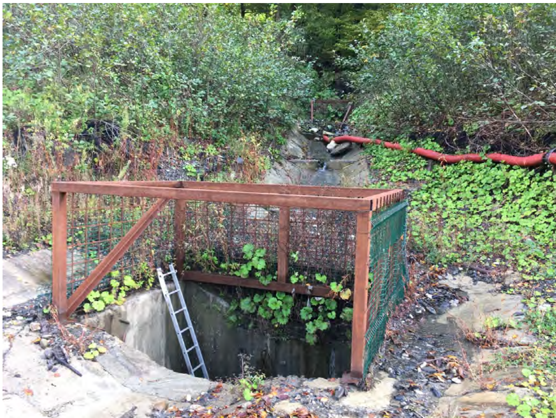
Рисунок 4.4.16. Водоприемник с нагорной части дороги, обнесенный металлической решеткой на ручье б/н №8
