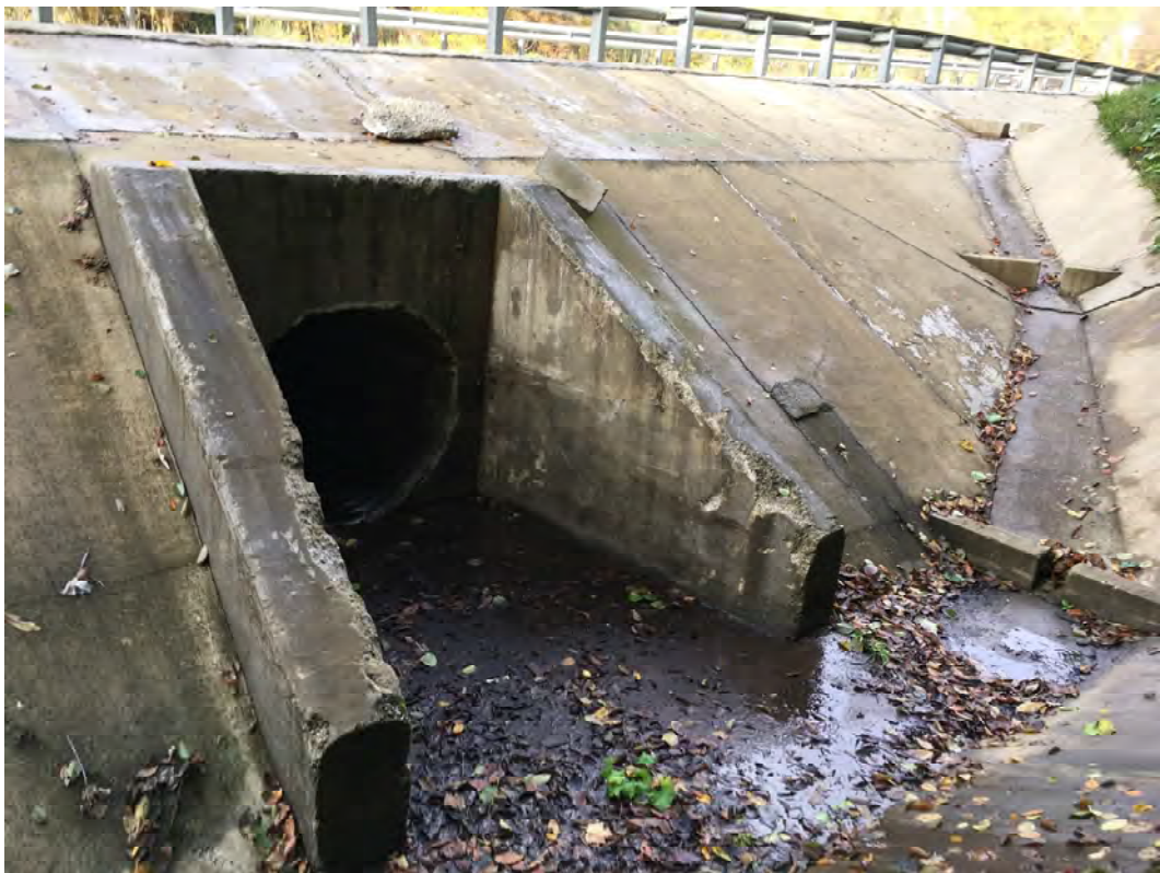
Рисунок 4.4.6 - Водоприемник с нагорной части дороги ручья б/н №4
