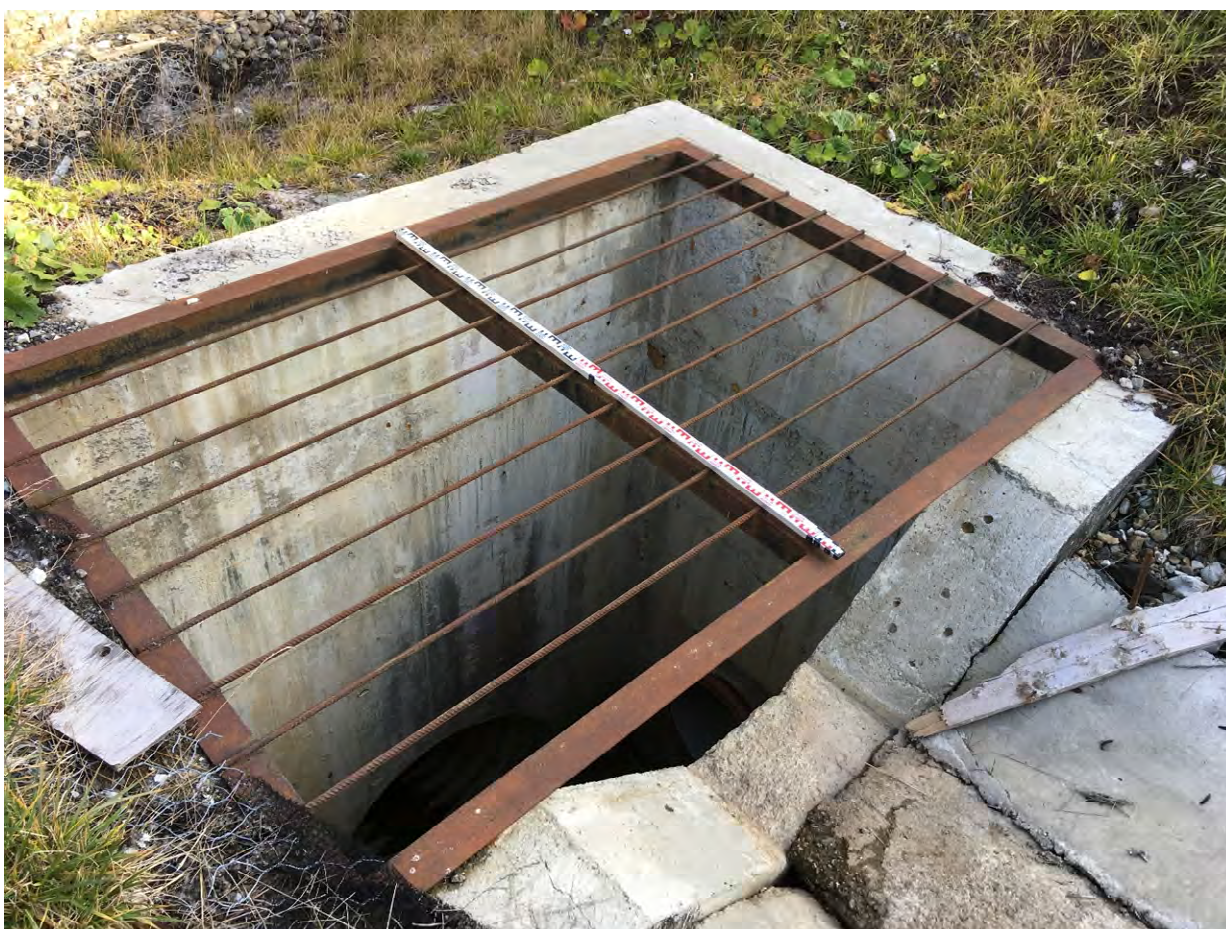
Рисунок 4.4.60 - Водоприемник с нагорной части дороги ручья б/н №25
