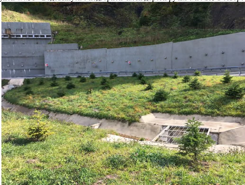
Рисунок 4.4.32 - Водоприемник с нагорной части дороги в створе №16
