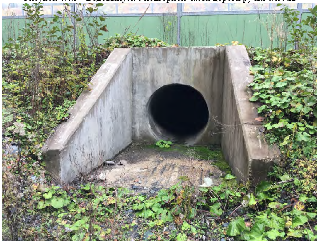
Рисунок 4.4.4 - Водоприемник с нагорной части дороги ручья б/н №3
