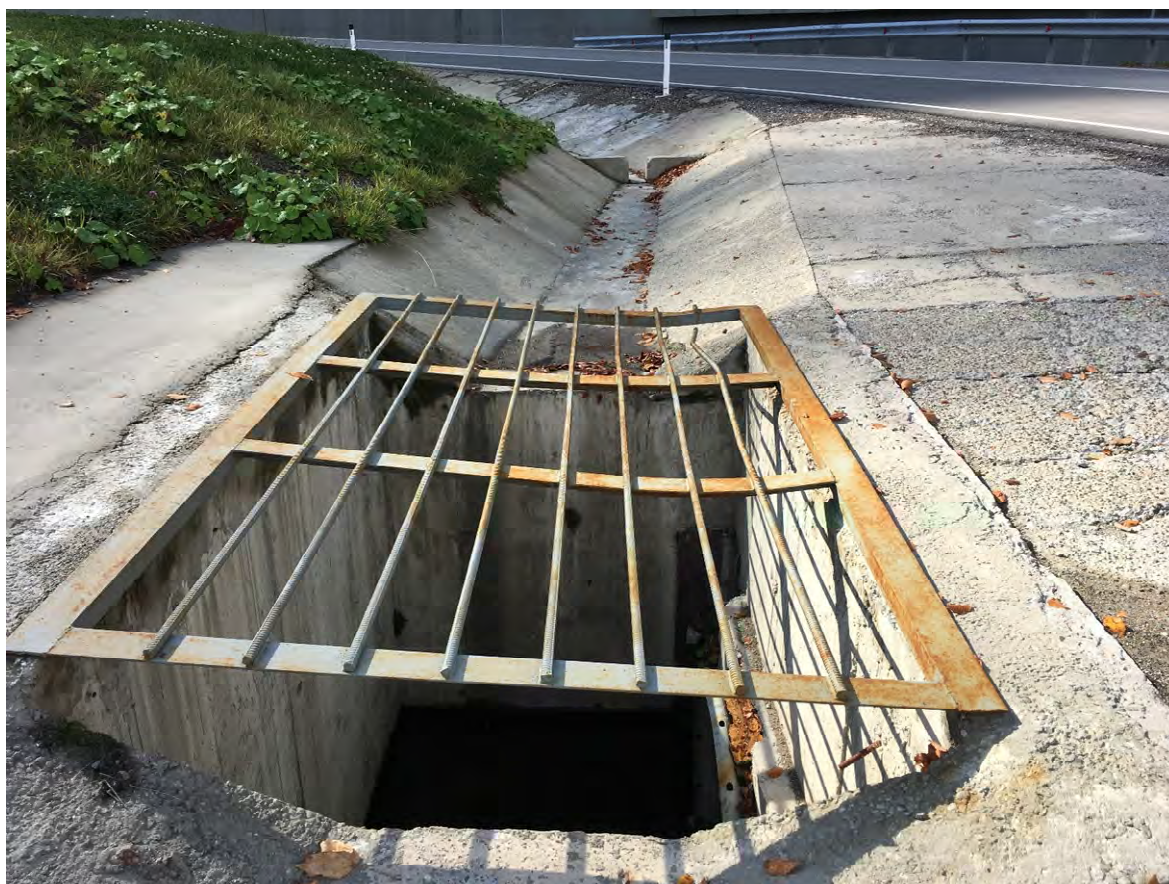
Рисунок 4.4.25 - Водоприемник с нагорной части дороги в створе №26
