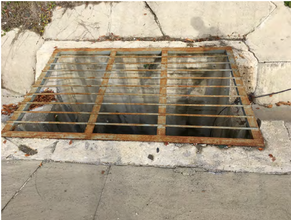
Рисунок 4.4.24 - Водоприемник с нагорной части дороги в створе №18
