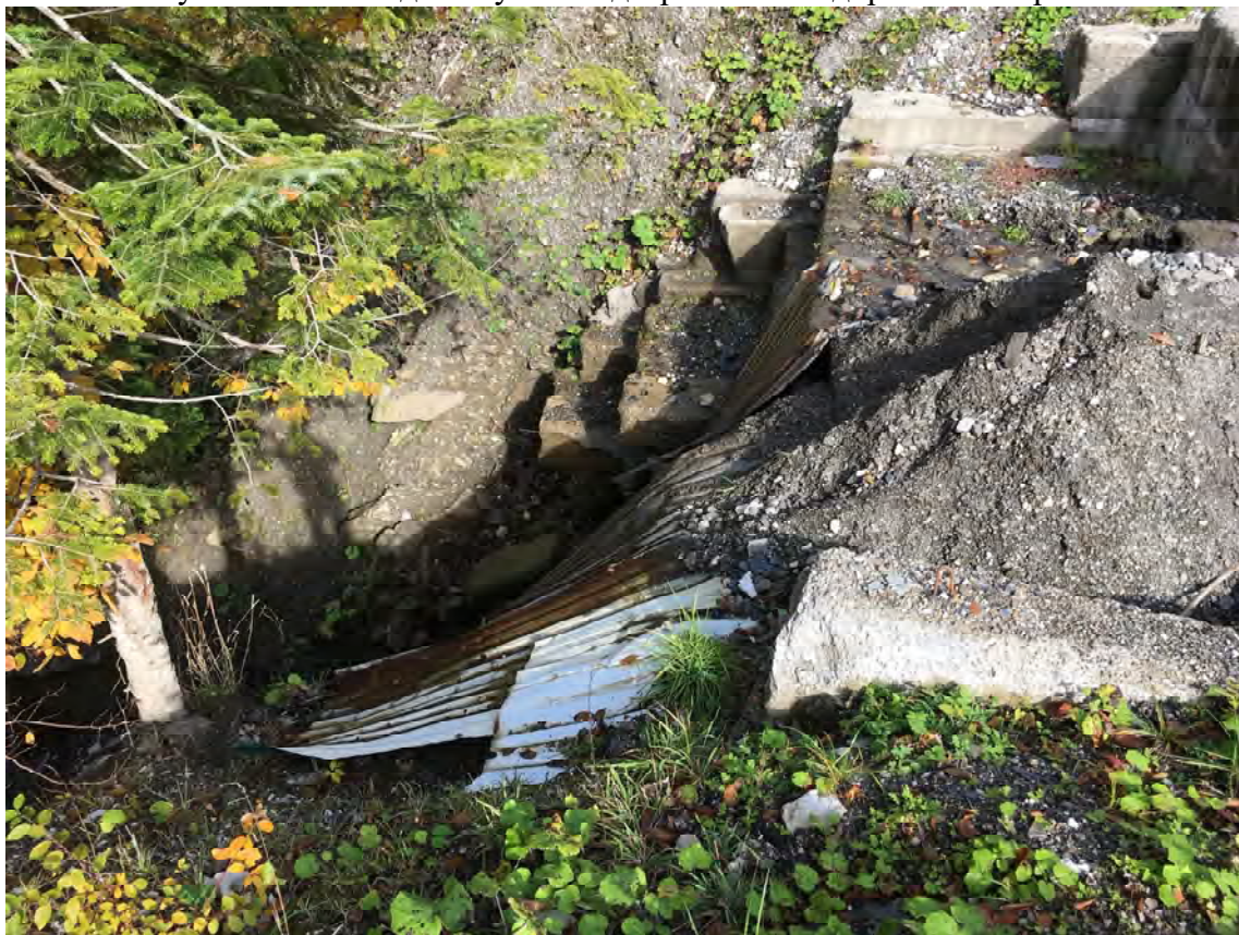
Рисунок 4.4.19. Перепад водовыпуска в створе №9
