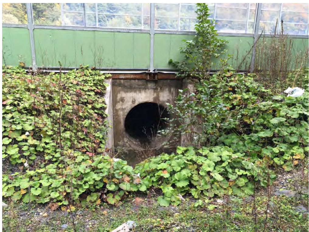
Рисунок 4.4.2 - Водоприемник с нагорной части дороги ручья б/н №2
