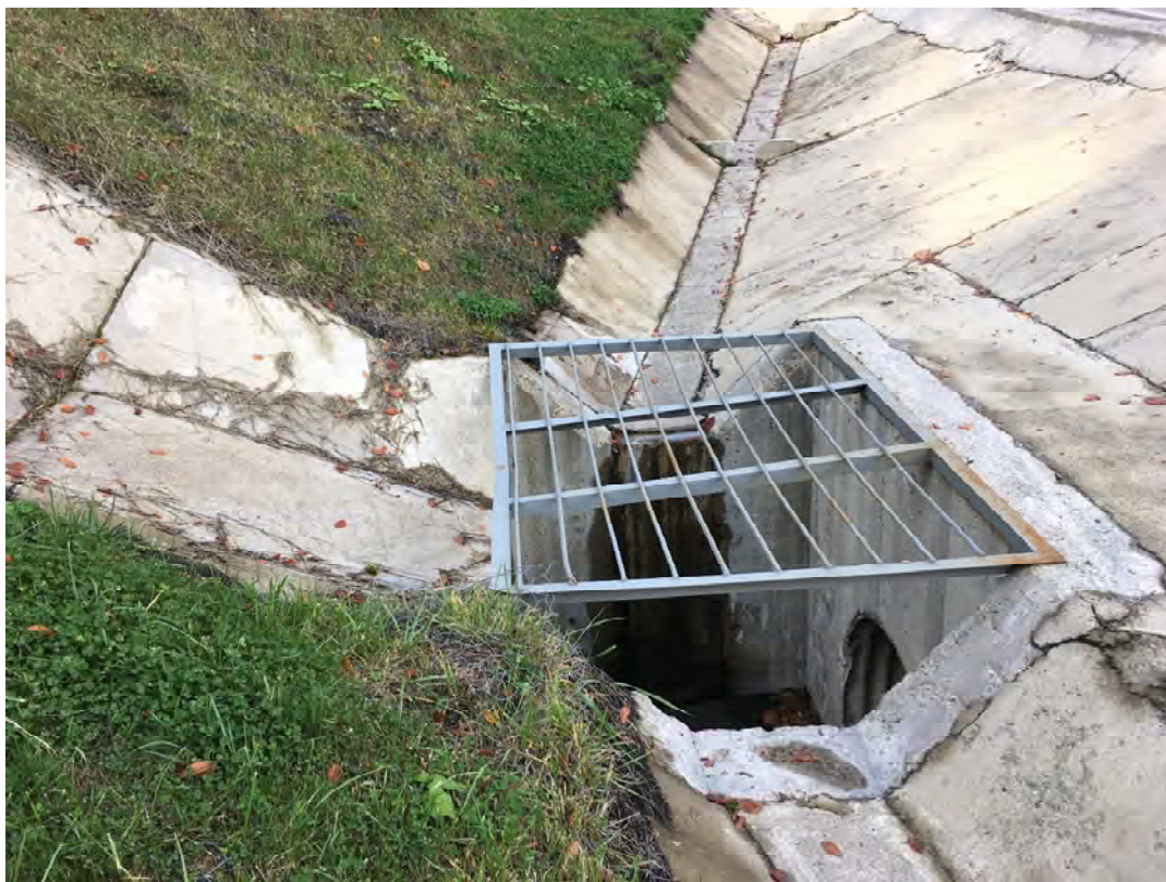
Рисунок 4.4.44 - Водоприемник с нагорной части дороги
