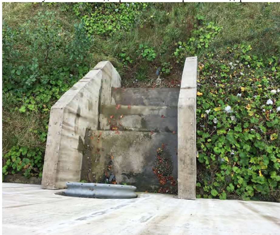
Рисунок 4.4.28 - Водовыпуск с подгорной части дороги
