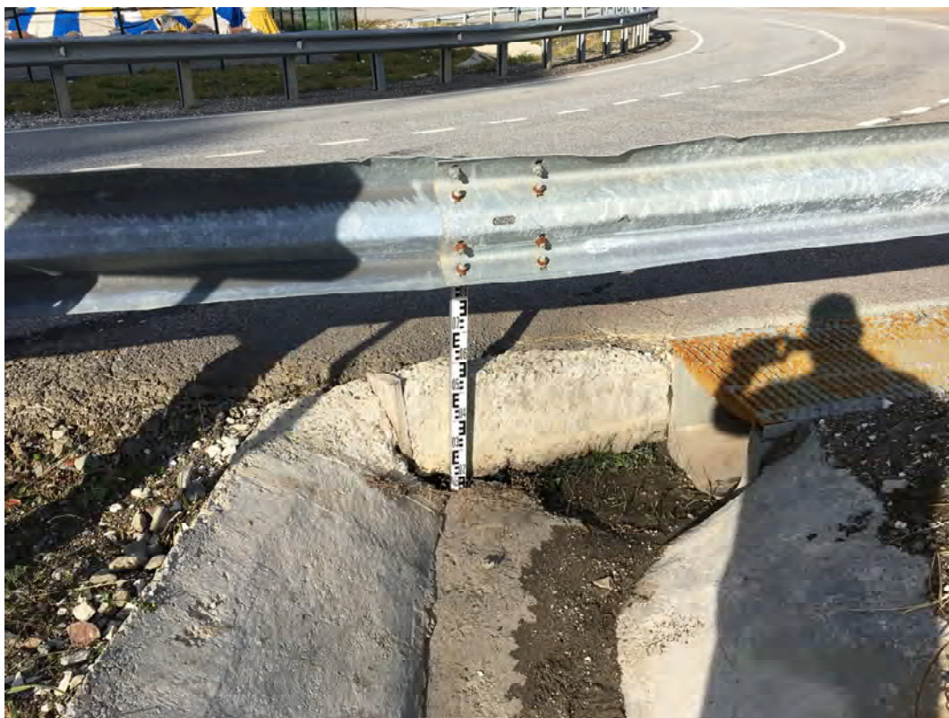
Рисунок 4.4. 61 - Подмыв автодороги с левой стороны ручьем б/н №26 в створе №42
