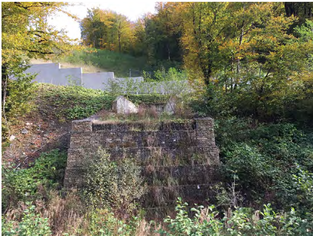
Рисунок 4.4.15 - Водовыпуск с подгорной части дороги
