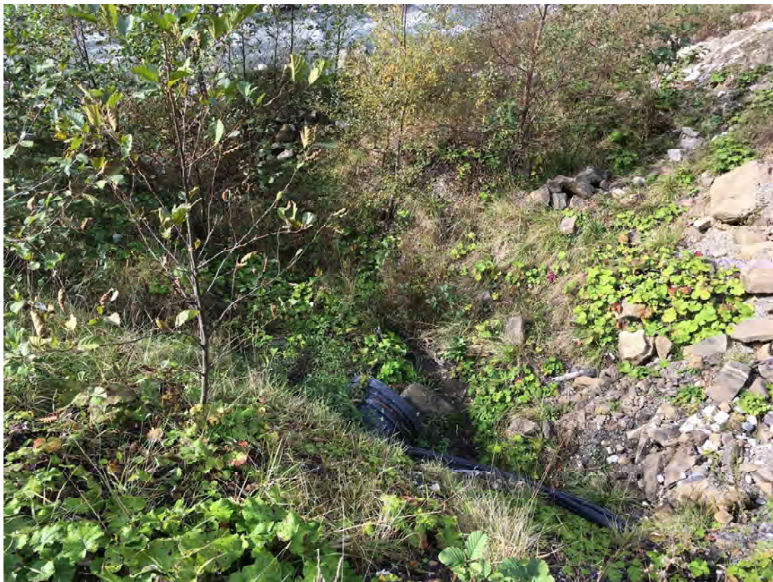
Рисунок 4.4.7 - Водовыпуск с подгорной части дороги ручья б/н №4
