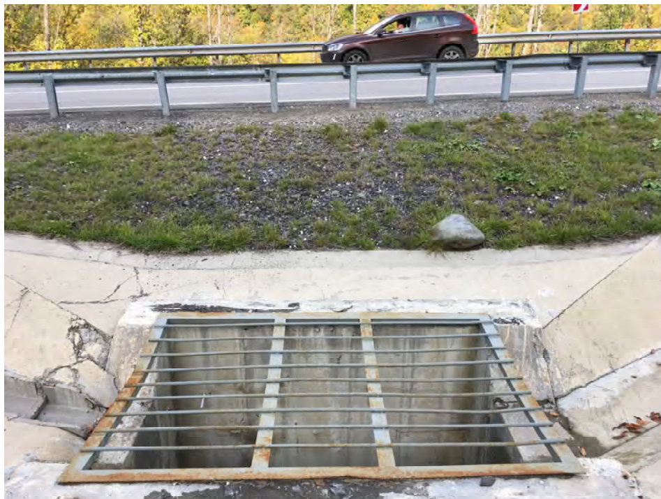
Рисунок 4.4.27. Водоприемник с нагорной части дороги
