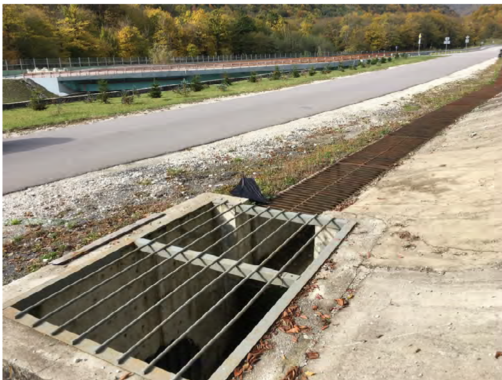
Рисунок 4.4.8 - Водоприемник с нагорной части дороги ручья б/н №5
