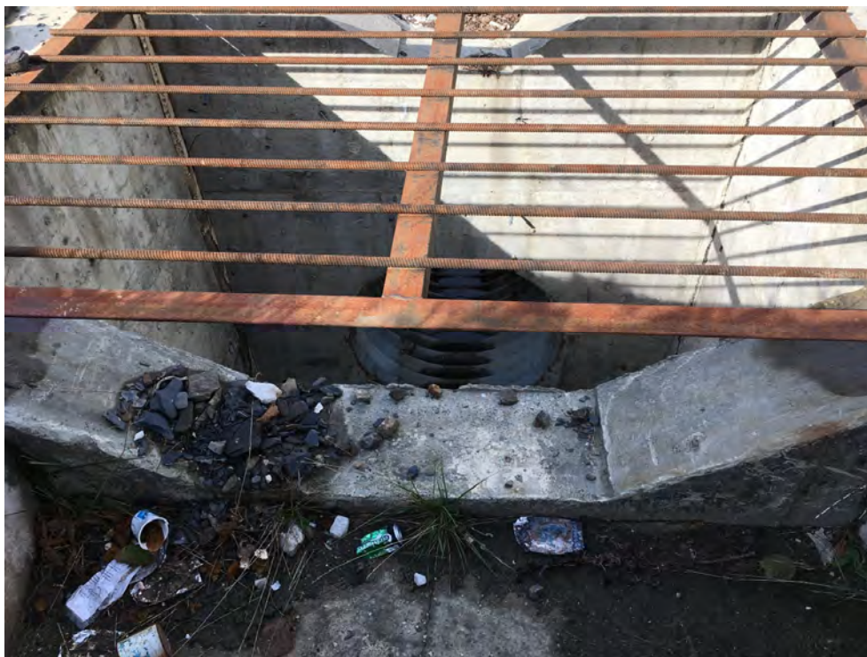
Рисунок 4.4. 22 - Водоприемник с нагорной части дороги в створе №15
