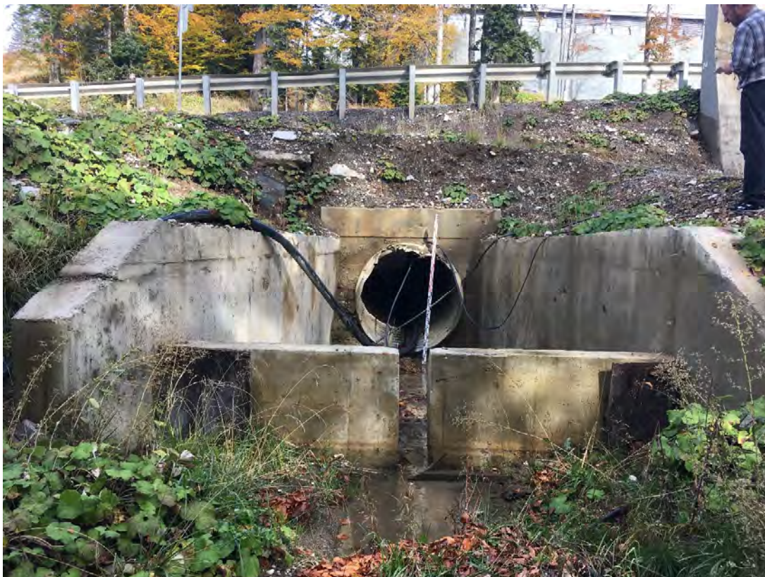
Рисунок 4.4.59 - Водовыпуск с подгорной части дороги ручья б/н №25
