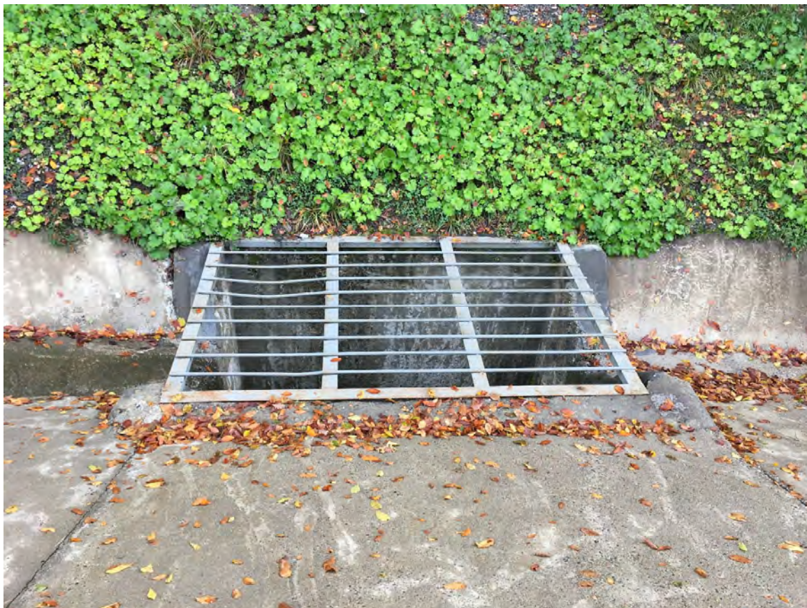
Рисунок 4.4.12 - Водоприемник с нагорной части дороги ручья б/н №6
