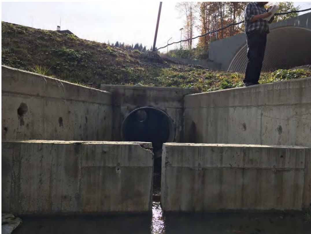
Рисунок 4.4.65 - Водовыпуск с подгорной части дороги в створе №48 ручья б/н №32, диаметр трубы 1 м.
