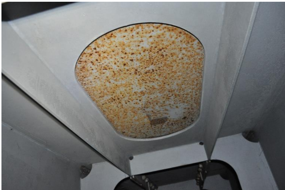
Рис. 3.2.3. Поверхностная коррозия верхнего перекрывающего металлического листа балки Б-3 пролетного строения. Фото 23.09.2021г.
