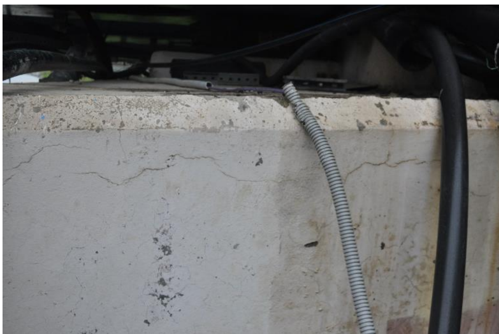
Рис. 3.4.1. Коррозионные трещины в теле ригеля опоры №1 (с торца, слева). Фото 23.09.2021г.
