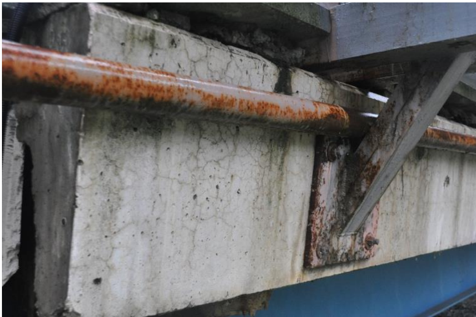
Рис. 3.1.23. Сетка трещин в бетоне карнизного блока над опорой №2, слева (деградационное разрушение бетона). Фото 23.09.2021г.
