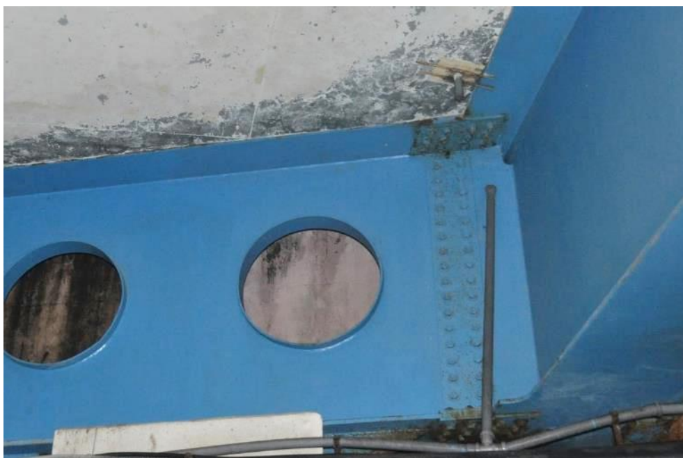
Рис. 3.1.7. Трубопровод для отвода дренажной воды не подсоединен к дренажной трубке. Вода из дренажной трубки попадает на ригель крайней опоры №2. Фото 23.09.2021г.
