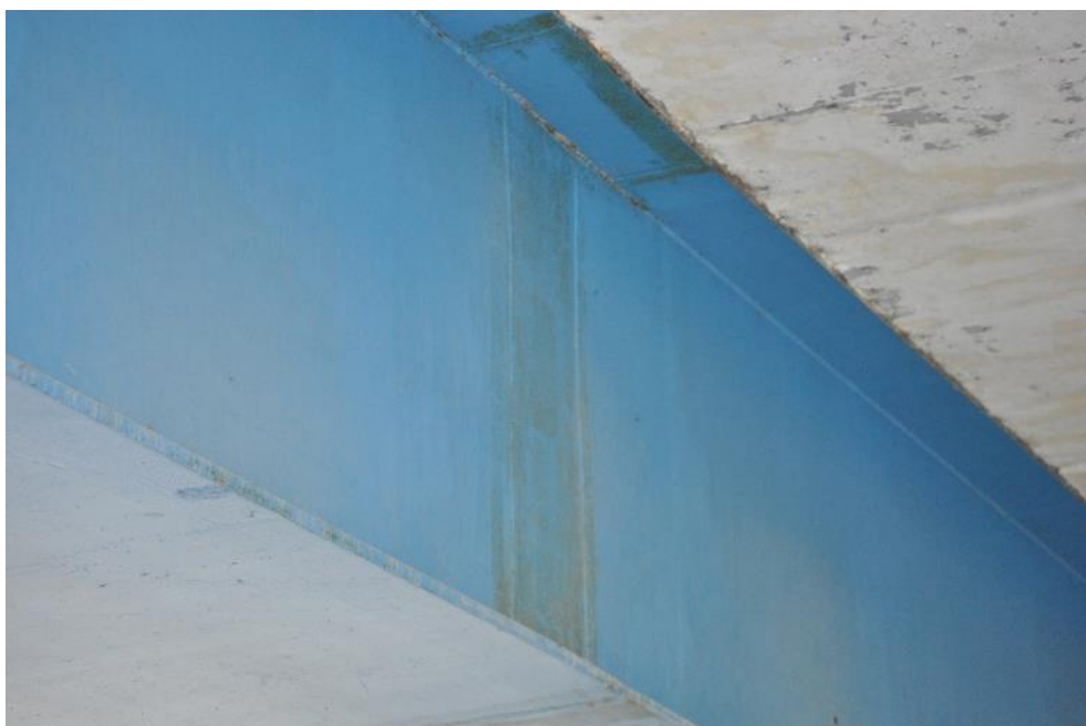
Рис. 3.2.4. Поверхностная коррозия металла стенки балки Б-1 в местах устройства сварных стыков (снаружи). Фото 23.09.2021г.
