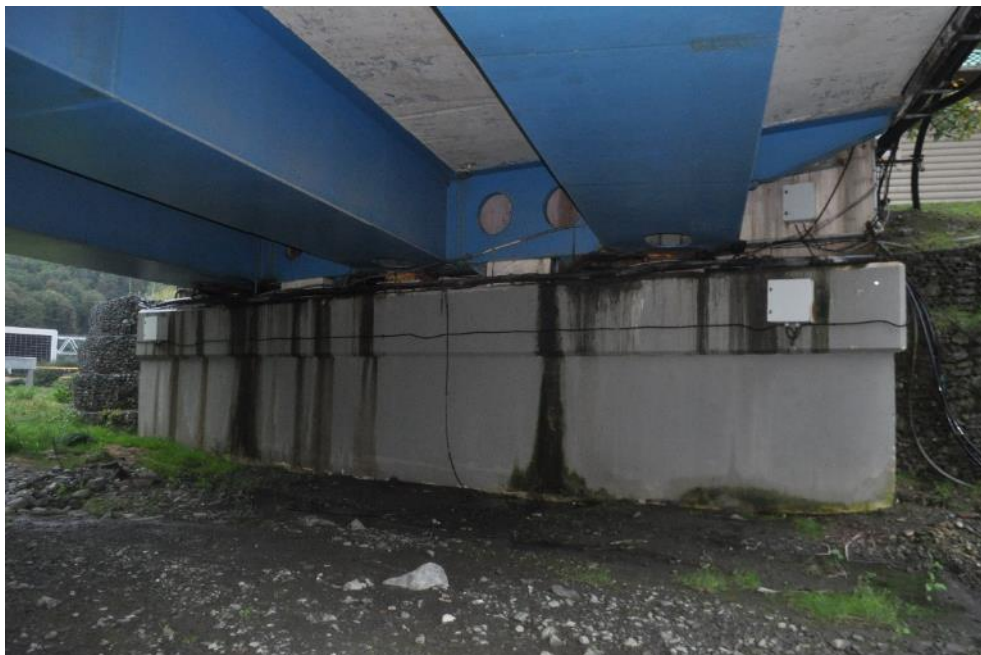
Рис. 3.4.4. Следы интенсивных протечек на элементах крайней опоры №2 через негерметичный деформационный шов над опорой. Фото 23.09.2021г.
