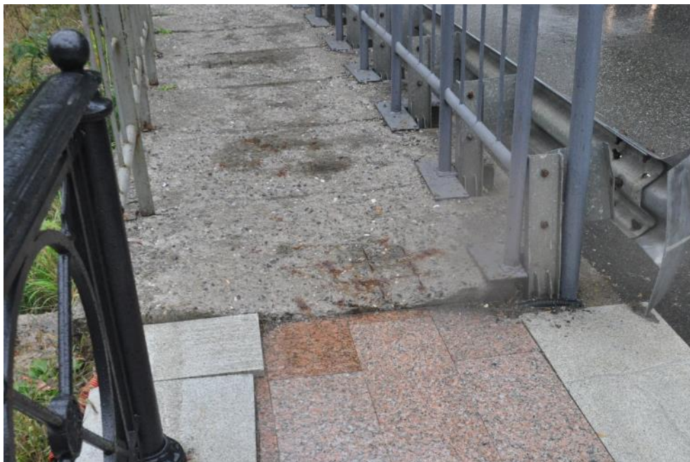
Рис. 3.1.14. Деградиционное разрушение бетона тротуарных плит с обнажением зерен крупного заполнителя и обнажением арматуры на подходе №1, слева. Фото 23.09.2021г.
