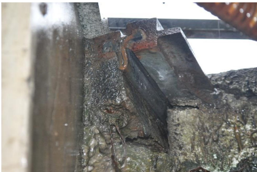
Рис. 3.1.26. Фактический температурный зазор (10 мм) над крайней опорой №2 мостового сооружения не соответствует температуре окружающей среды Фото 23.09.2021г.
