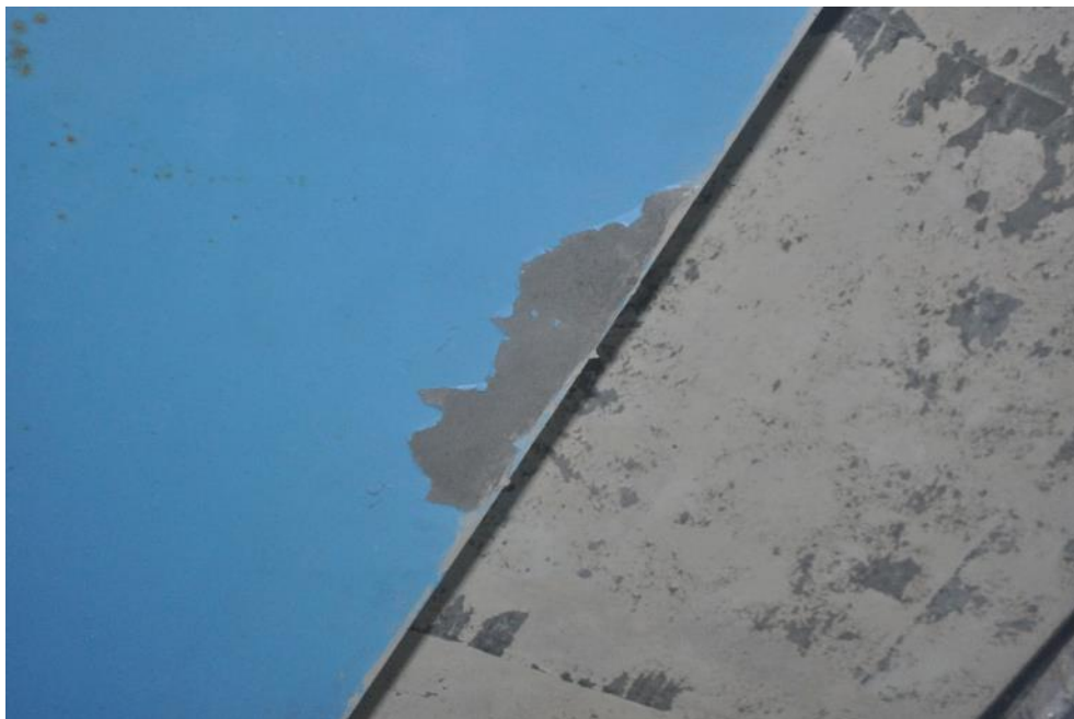
Рис. 3.2.9. Отслоение защитного лакокрасочного покрытия нижнего пояса балки Б-1 в середине пролета. Шелушение защитного лакокрасочного покрытия плиты проезжей части. Фото 23.09.2021г.
