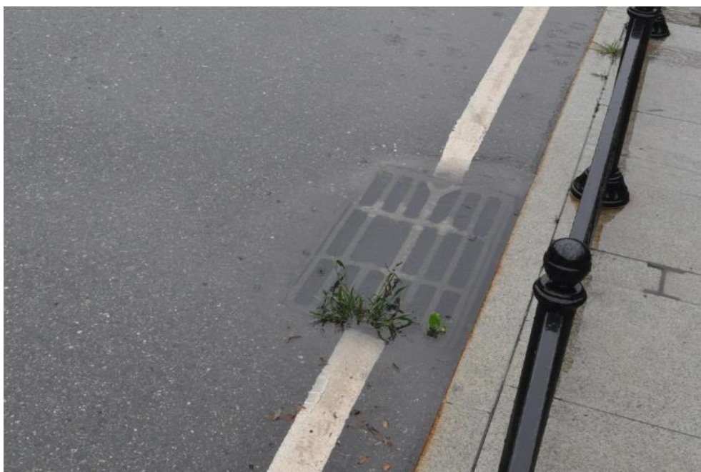
Рис. 3.6.8. Застой воды в дождеприемном колодце на подходе №1 к мосту, справа. Дождеприемный колодец не функционирует. Фото 23.09.2021г.
