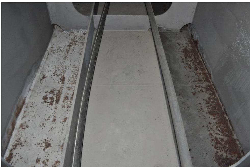
Рис. 3.2.30. Коррозия нижнего пояса балки Б-1 (изнутри) Фото 23.09.2021г.
