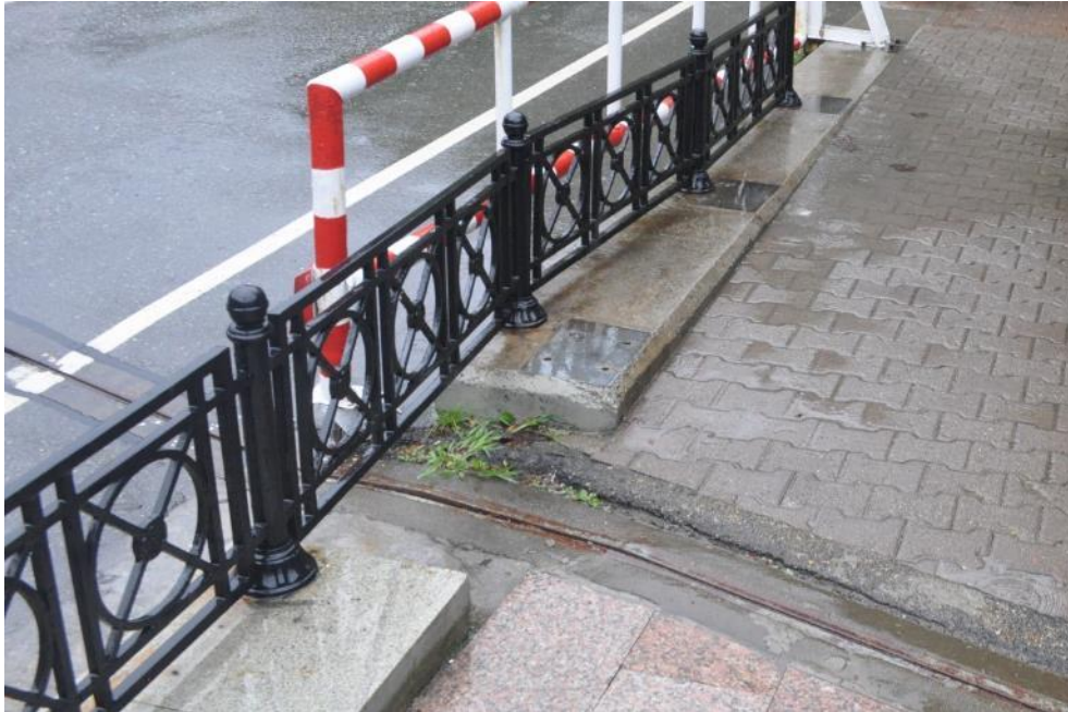
Рис. 3.1.8. Декоративное металлическое ограждение между проезжей частью моста и проехой частью правостороннего тротуара (над опорой №2). Отсутствие участка, обеспечивающего температурные перемещения. Фото 23.09.2021г.
