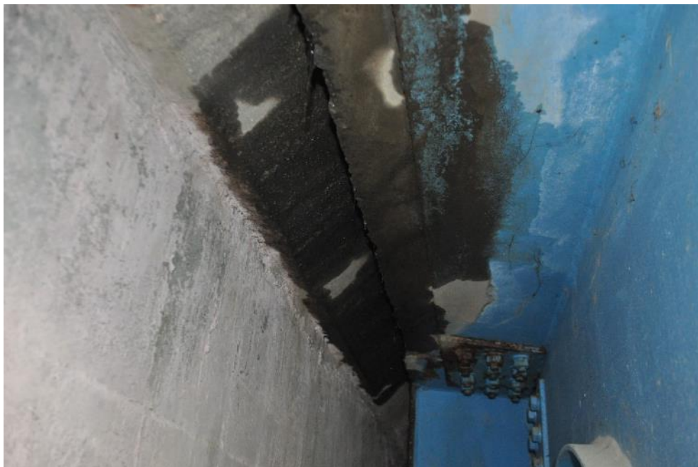
Рис. 3.2.33. Замачивание поверхностей плиты проезжей части и шкафной стенки опоры №2 ввиду негерметичности деформационного шва Фото 23.09.2021г.
