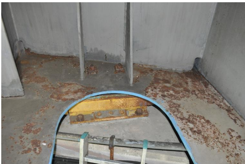
Рис. 3.2.18. Коррозия листа нижнего пояса балки Б-2 (изнутри) над крайней опорой №2 моста. Фото 23.09.2021г.
