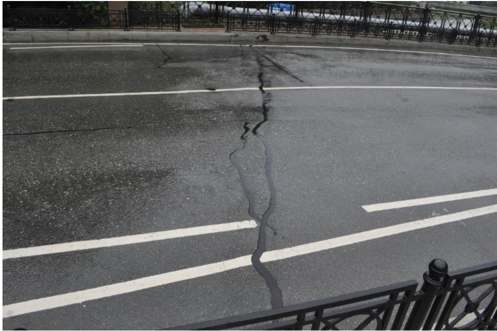
Рис. 1.3. Асфальтобетонное покрытие в зоне деформационного шва закрытого типа Thorma Joint над крайней опорой №1 мостового сооружения. Вид справа. Фото 23.09.2021г.
