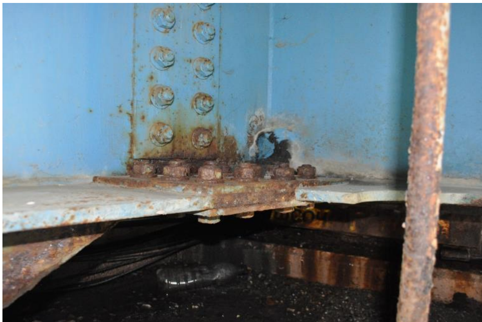
Рис. 3.2.21. Коррозия болтового соединения монтажного стыка домкратной балки над крайней опорой №2 моста. Фото 23.09.2021г.
