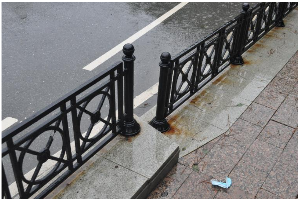
Рис. 3.6.3. Отсутствует участок декоративного металлического ограждения в начале моста, слева. Ограждения установлены на разной высоте. Несоответствие конструктивного исполнения ограждения нормативным требованиям Фото 23.09.2021г.
