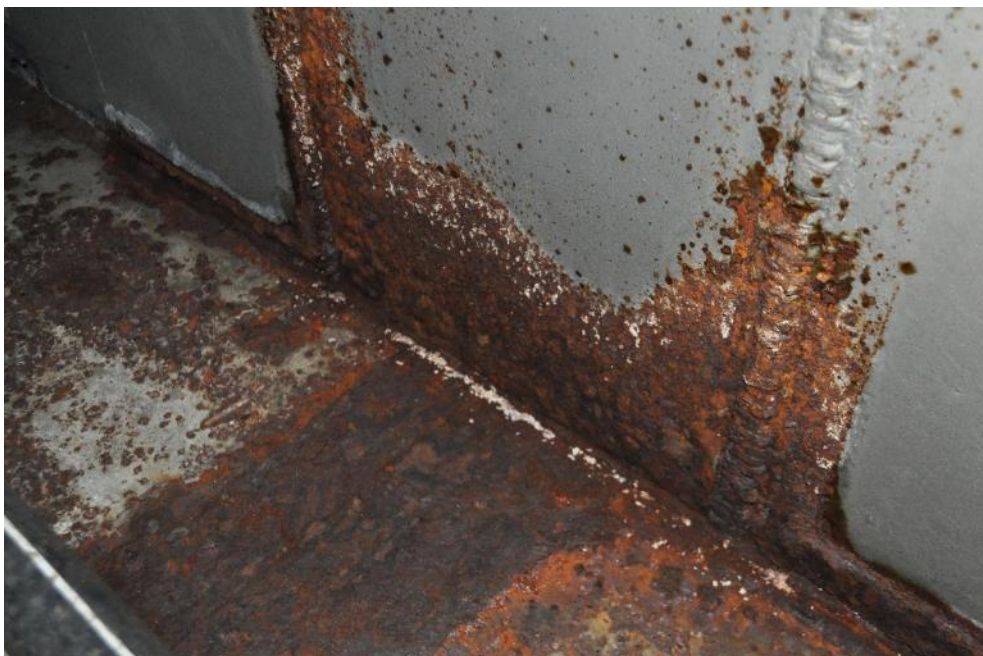
Рис. 3.2.28. Слоистая коррозия металла нижнего пояса и стенок главной балки Б-1 в зоне сварных стыков Фото 23.09.2021г.
