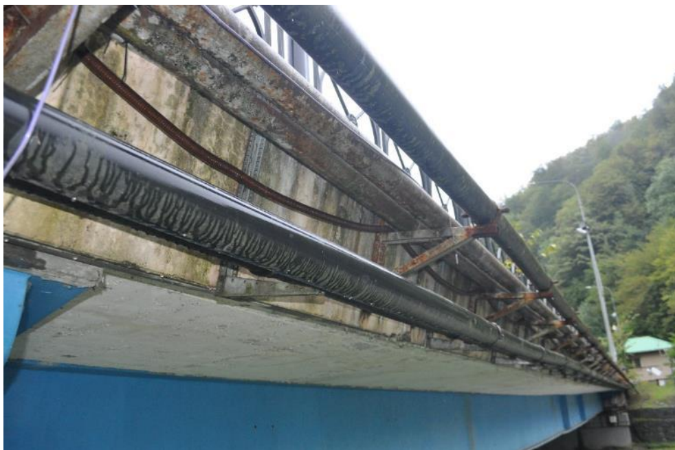
Рис. 3.1.21. Следы протечек и замачивания конструкции карнизных блоков справа, над крайней опорой №1 моста (со стороны фасада). Фото 23.09.2021г.
