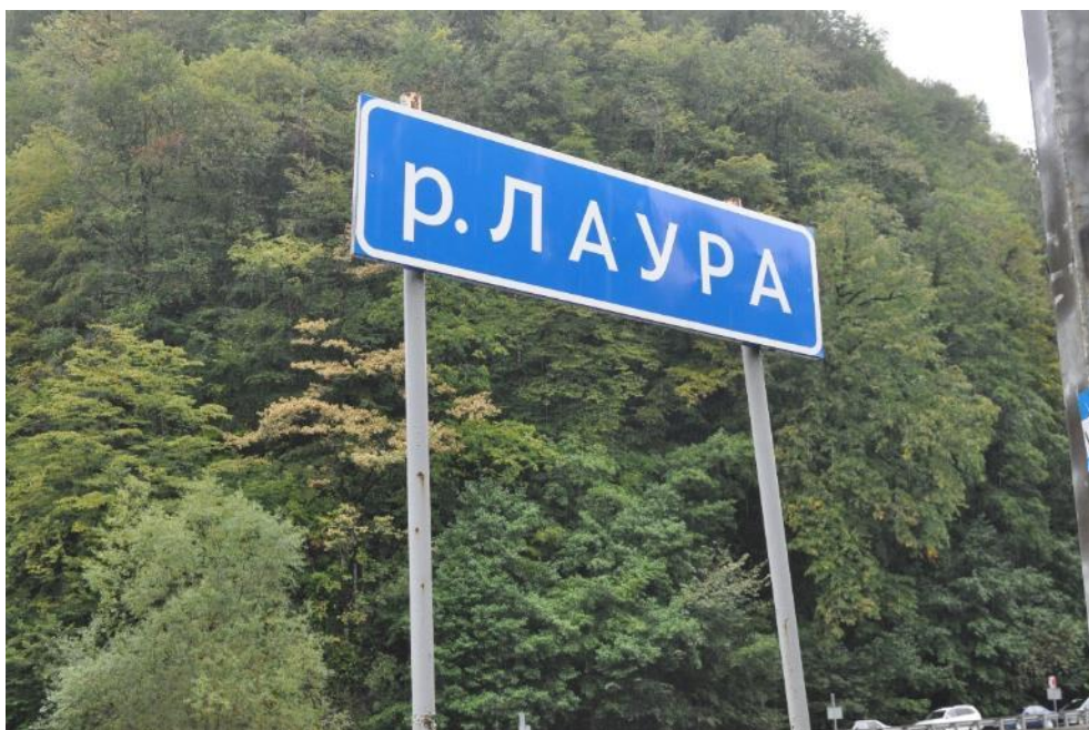
Рис. 3.6.6. Дорожный знак 6.11 «Наименование объекта – р. Лаура» на подходе №2 к мосту. Коррозия на поверхности стоек дорожного знака. Несоответствие наименования объекта на знаке фактическому названию реки. Фото 23.09.2021г.
