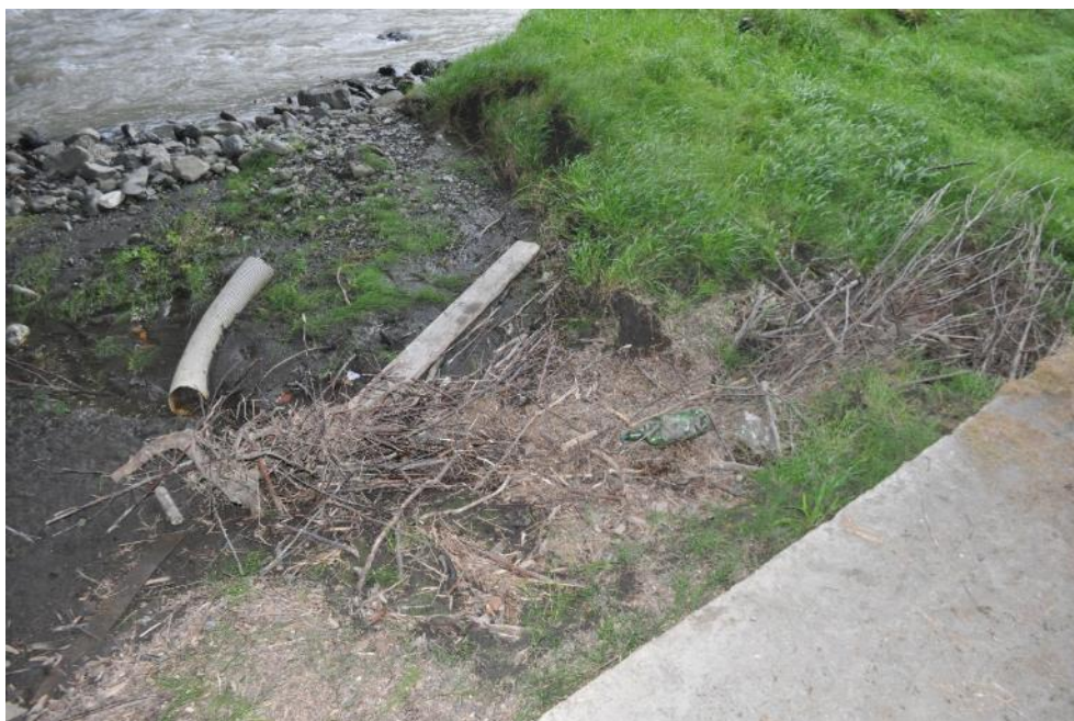
Рис. 3.11.1. Русло реки Ачипсе в подмостовой зоне, у опоры №1 моста. Скопление веток и прочего мусора. Фото 23.09.2021г.
