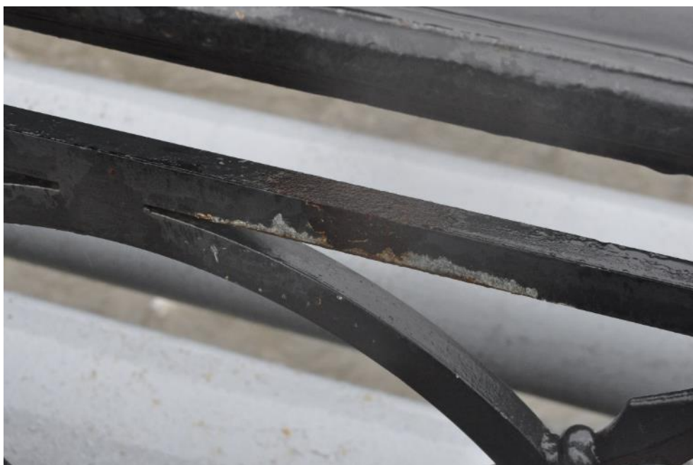
Рис. 3.1.17. Нарушение защитного лакокрасочного покрытия, коррозия металлических элементов левостороннего перильного ограждения моста. Фото 23.09.2021г.
