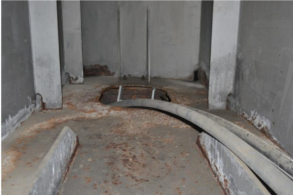
Рис. 3.2.27. Коррозия металла нижнего пояса балки Б-1 по кромке отверстия (над крайней опорой №2 моста, внутри). Фото 23.09.2021г.
