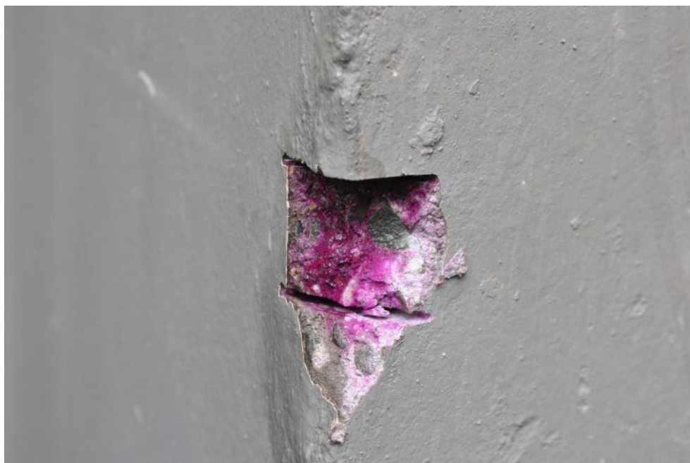
Рис. 4.2.5. Тело крайней опоры №2, справа. Окрашивание свежесделанного скола защитного слоя бетона в розовый цвет при нанесении пульверизацией 0,1% спиртового раствора фенолфталеина. Бетон карбонизирован на глубину, не превышающую толщину защитного слоя
