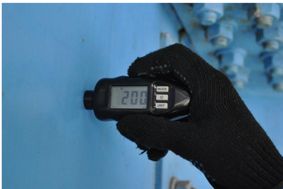
Рис. 4.4.3. Определение толщины защитного лакокрасочного покрытия консоли балки Б-3 над опорой №1 при помощи толщиномера защитных покрытий «CARSYS DPM-816»
