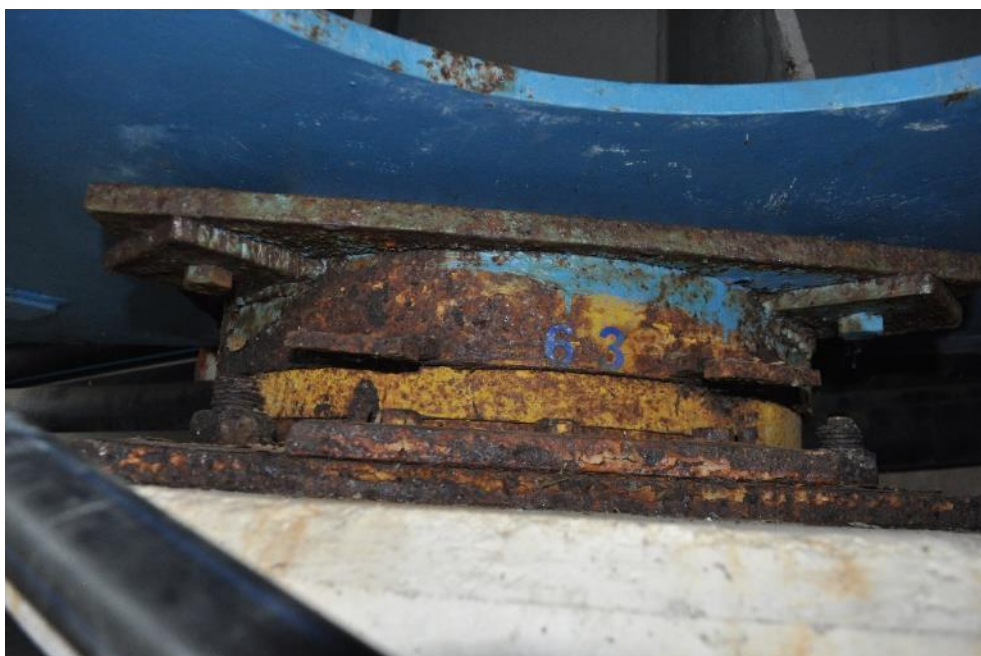
Рис. 3.3.2. Пластинчатая коррозия защитных кожухов и опорных пластин опорной части под балкой Б-3 пролетного строения на опоре №2. Фото 23.09.2021г.
