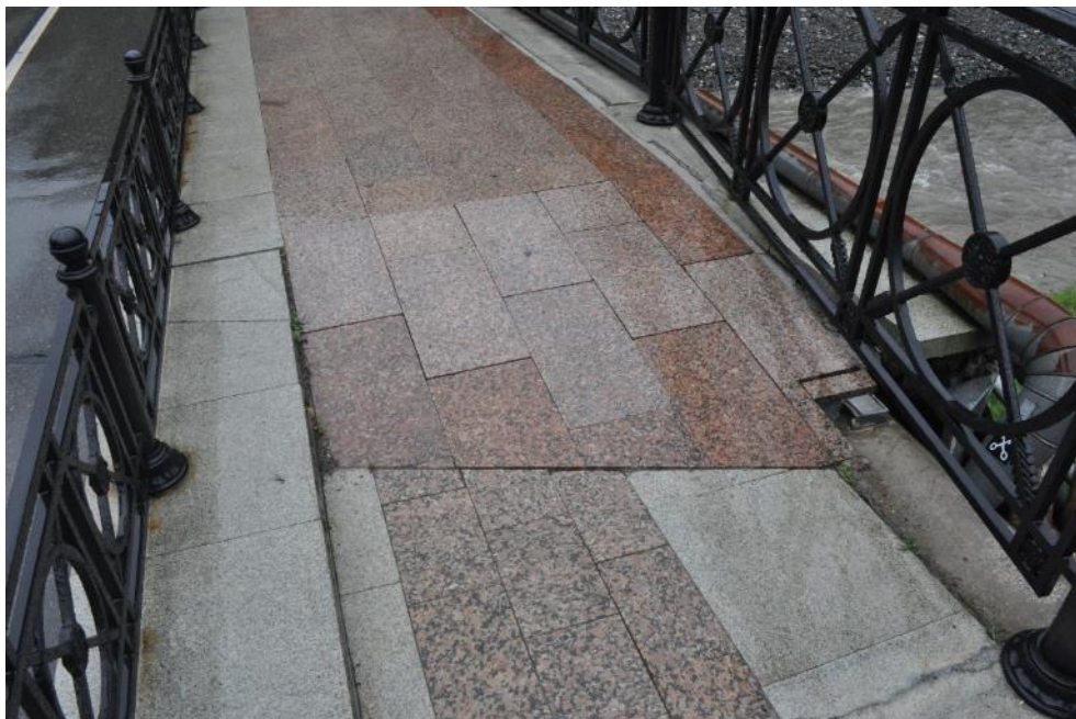
Рис. 3.1.12. Отсутствие зазора, обеспечивающего температурные перемещения, в покрытии правостороннего тротуара над опорой №1 моста. Фото 23.09.2021г.
