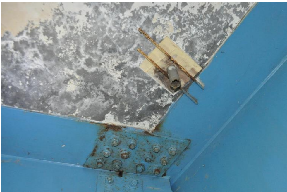
Рис. 3.2.35. Следы протечек и выщелачивания бетона плиты проезжей части в зоне дренажных трубок над опорой №2 моста. Фото 23.09.2021г.
