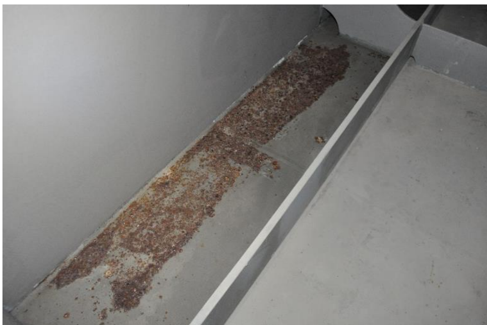
Рис. 3.2.16. Коррозия нижнего пояса балки Б-3 (изнутри) ввиду скопления воды (у правой стенки). Фото 23.09.2021г.
