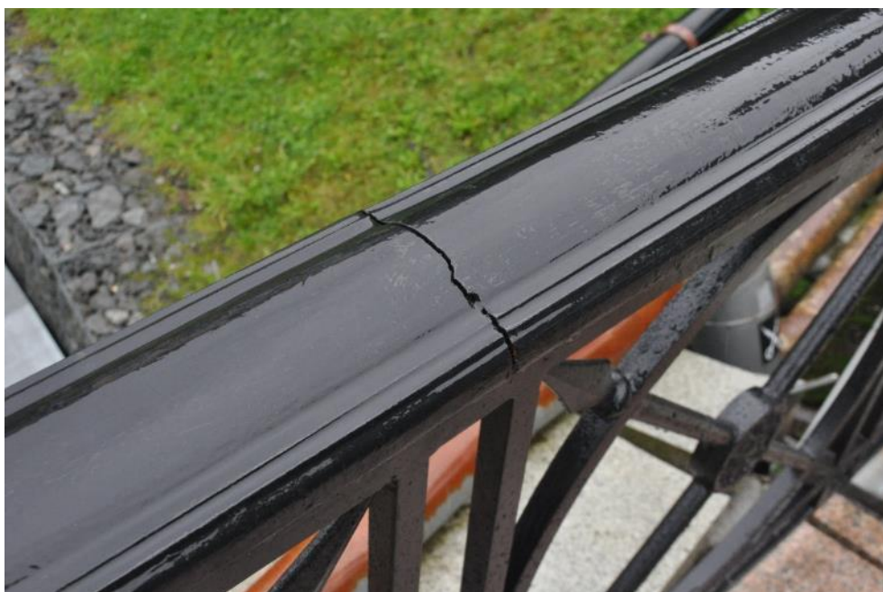
Рис. 3.1.15. Трещина в поручне правостороннего перильного ограждения в начале мостового сооружения в связи с отсутствием участка, обеспечивающего температурные перемещения. Фото 23.09.2021г.
