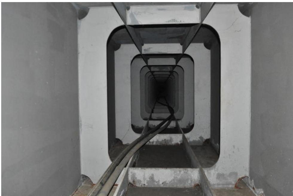
Рис. 3.2.26. Хаотичное расположение инженерных коммуникаций внутри балки Б-1 пролетного строения моста. Фото 23.09.2021г.
