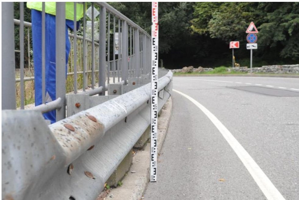
Рис. 3.6.5. Недостаточная высота (0,65 м) левостороннего силового барьерного ограждения на подходе №2 к мостовому сооружению. Фото 23.09.2021г.
