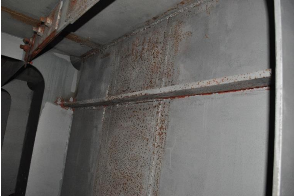
Рис. 3.2.23. К стенке балки Б-2 у сварного стыка приварен непроектный элемент. Фото 23.09.2021г.
