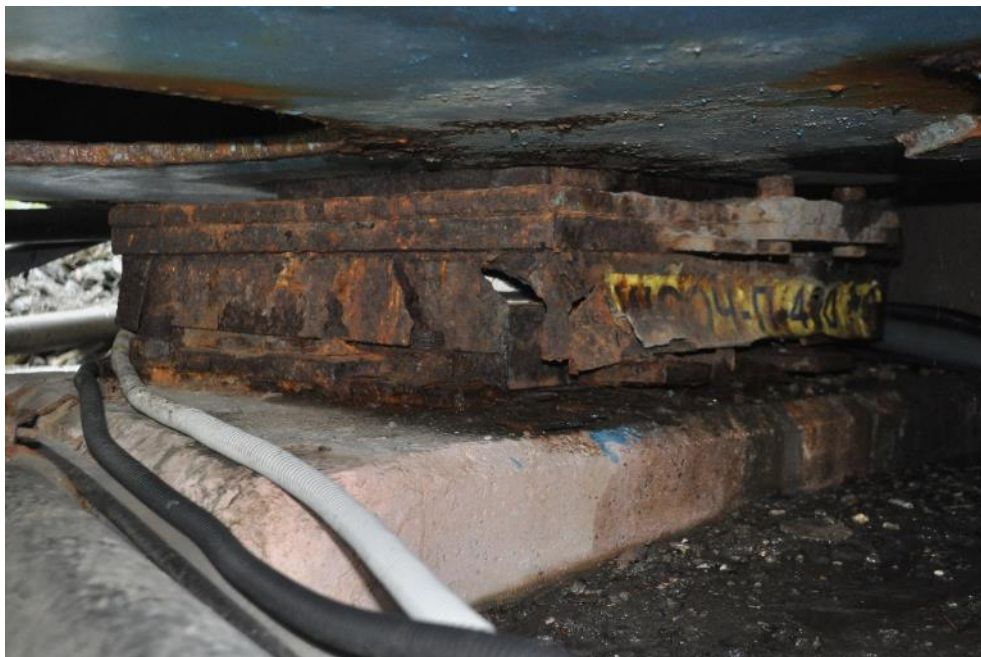
Рис. 3.3.1. Пластинчатая коррозия защитных кожухов и опорных пластин опорной части под балкой Б-1 пролетного строения на опоре №2. Фото 23.09.2021г.
