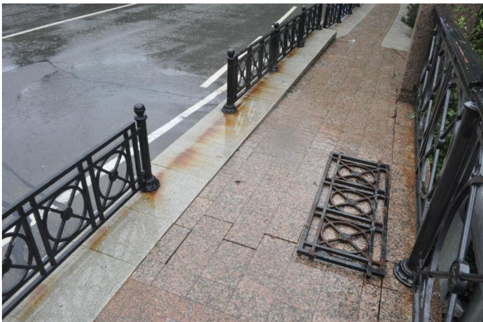
Рис. 3.1.9. Секция левостороннего металлического декоративного ограждения над крайней опорой №1 демонтирована. Следы ржавчины под секциями металлического ограждения. Фото 23.09.2021г.
