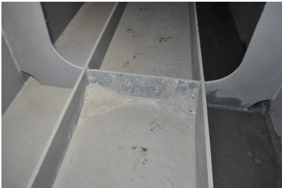
Рис. 3.2.15. Остатки строительных смесей внутри балки Б-3 пролетного строения моста (ближе к опоре №1). Фото 23.09.2021г.
