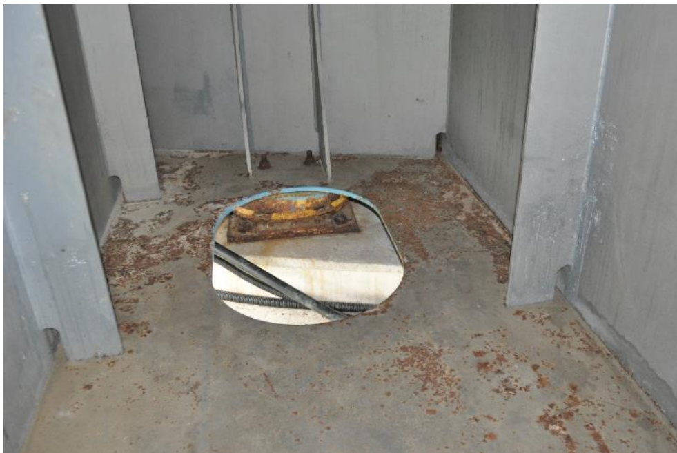
Рис. 3.2.17. Коррозия листа нижнего пояса балки Б-3 (изнутри) над крайней опорой №1 моста. Фото 23.09.2021г.
