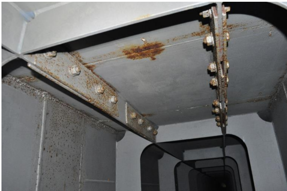
Рис. 3.2.5. Поверхностная коррозия накладок болтового соединения верхних ребер балки Б-3 пролетного строения. Коррозия сварного шва. Фото 23.09.2021г.
