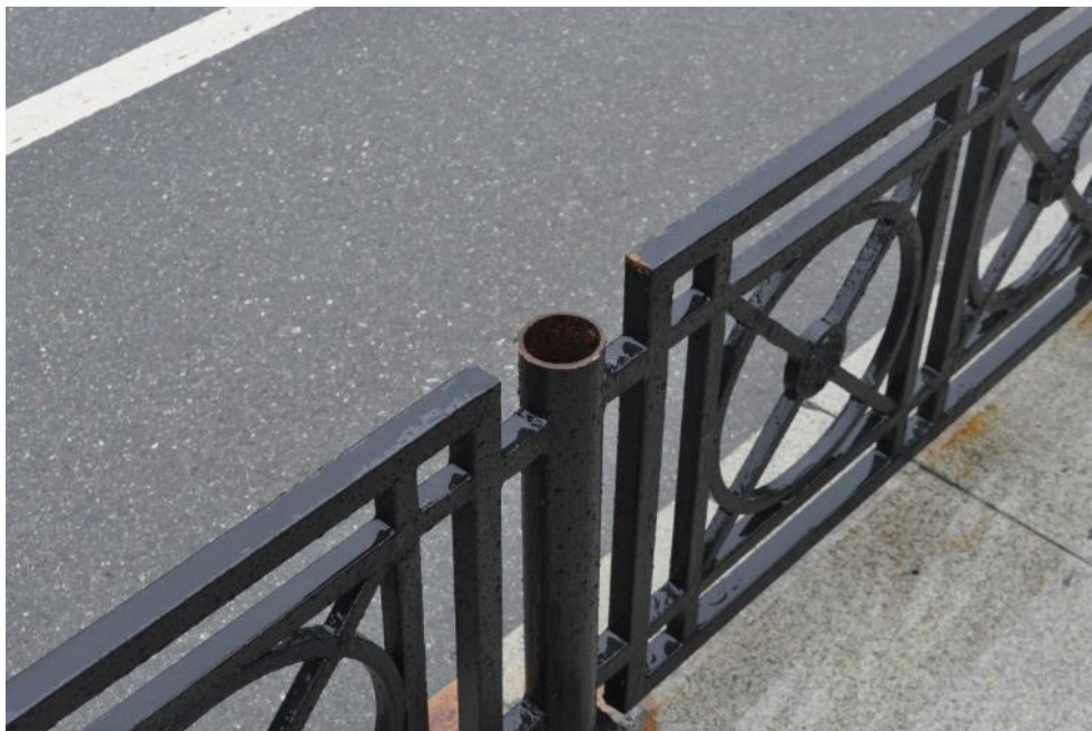
Рис. 3.1.10. Отсутствует декоративный элемент на стойке правостороннего металлического декоративного ограждения в середине пролета моста. Фото 23.09.2021г.
