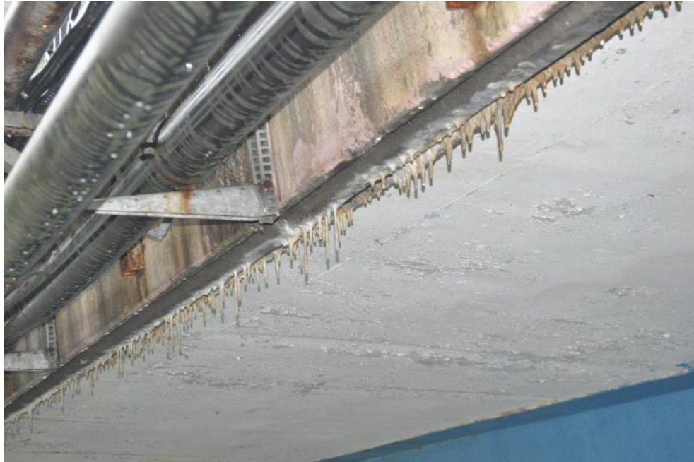
Рис. 3.1.20. Следы протечек и выщелачивания бетона с образованием сталактитов на карнизных блоках (справа, над крайней опорой №2 моста). Фото 23.09.2021г.
