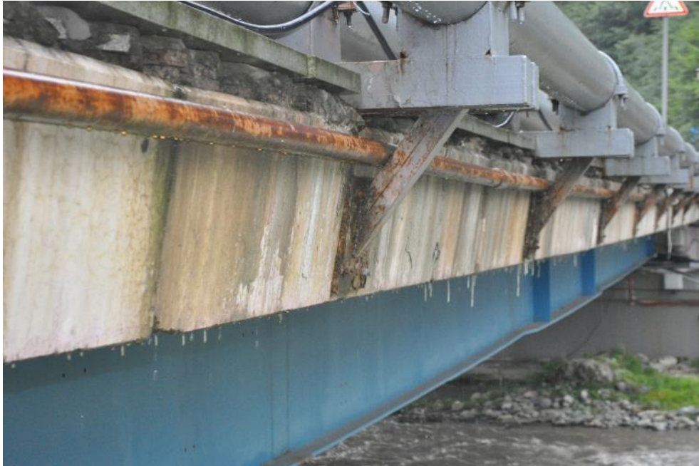
Рис. 3.1.22. Следы протечек и замачивания конструкции карнизных блоков слева, над крайней опорой №2 моста (со стороны фасада). Выщелачивания бетона карнизных блоков с образованием сталактитов. Фото 23.09.2021г.
