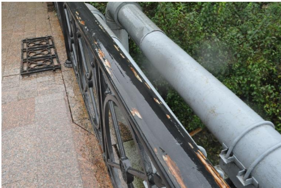
Рис. 3.1.16. Нарушение защитного лакокрасочного покрытия, коррозия поручня левостороннего перильного ограждения у опоры №1 моста. Фото 23.09.2021г.
