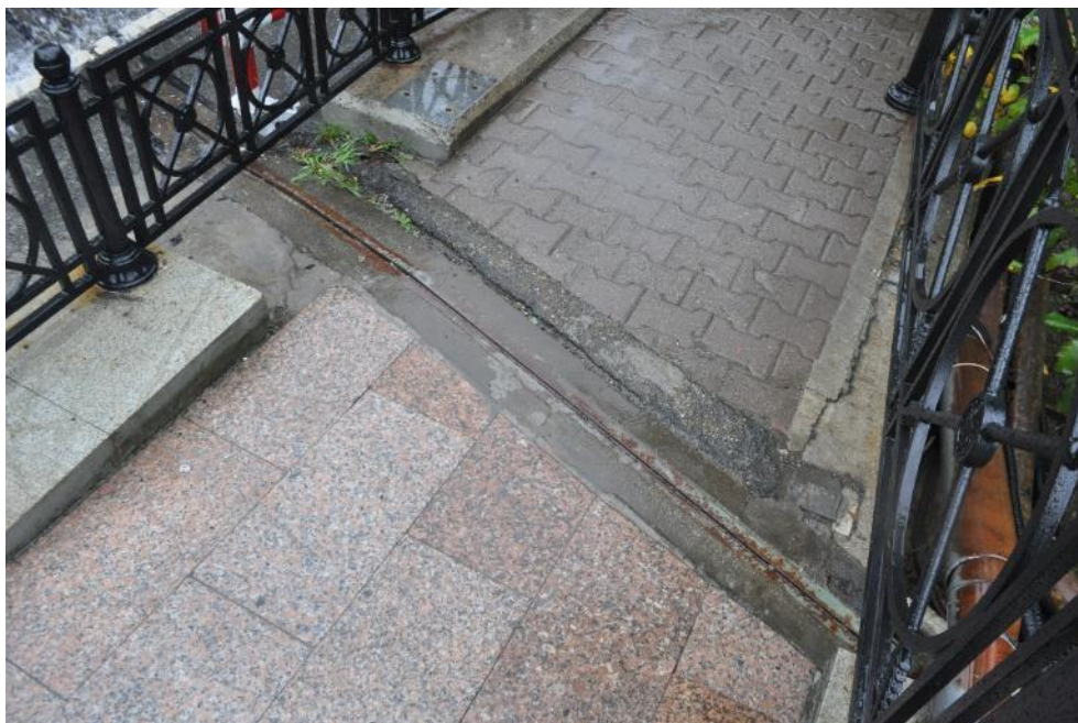
Рис. 3.1.24. Коррозия металлического окаймления деформационного шва заполненного типа с резиновым компенсатором над крайней опорой №2 моста (справа). Фото 23.09.2021г.
