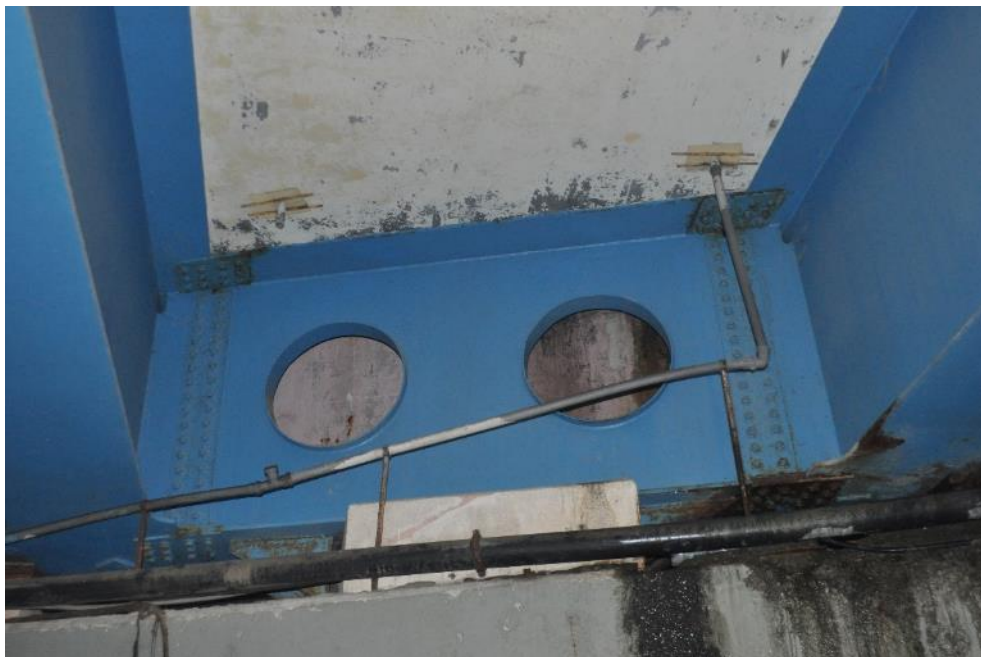
Рис. 3.1.6. Отсутствует участок трубопровода дренажной системы, вода из дренажной трубки попадает на ригель крайней опоры №2. Фото 23.09.2021г.
