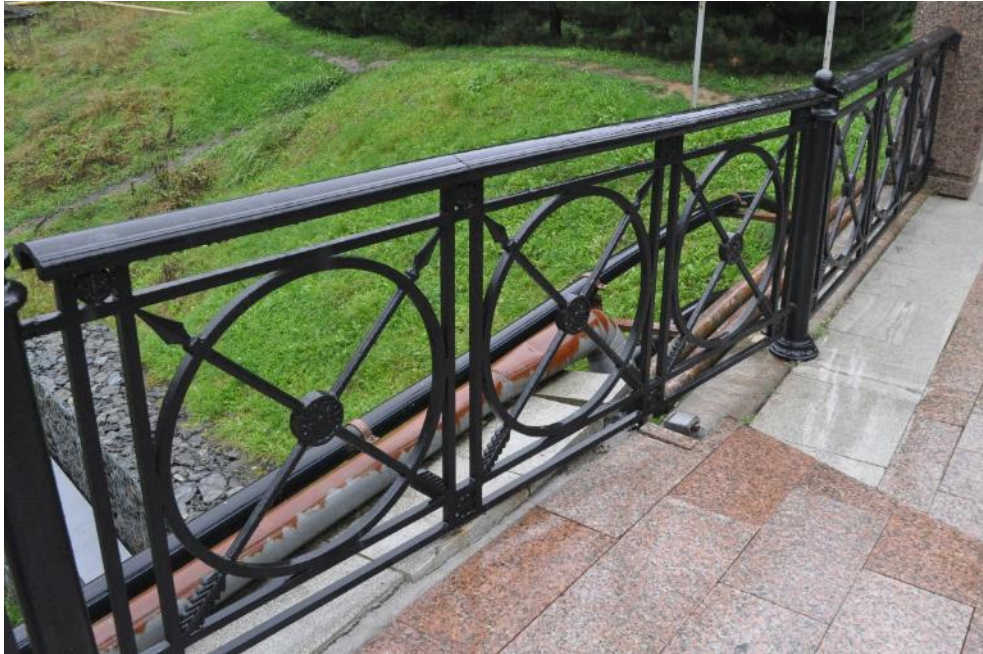
Рис. 3.1.18. Правостороннее перильное ограждение над крайней опорой №1 моста. Отсутствие участка, обеспечивающего температурные перемещения. Фото 23.09.2021г.
