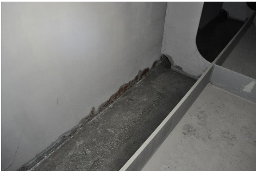
Рис. 3.2.13. Скопление влаги внутри балки Б-3 пролетного строения на нижем поясе у стенки балки. Фото 23.09.2021г.
