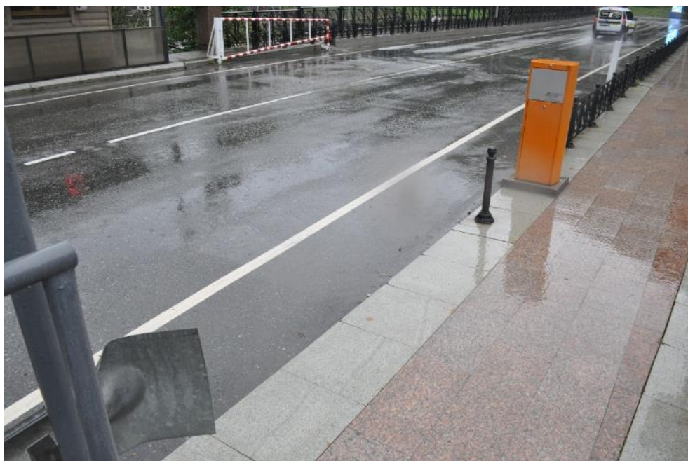
Рис. 3.6.4. Отсутствует участок силового ограждения на подходе №2, справа Фото 23.09.2021г.
