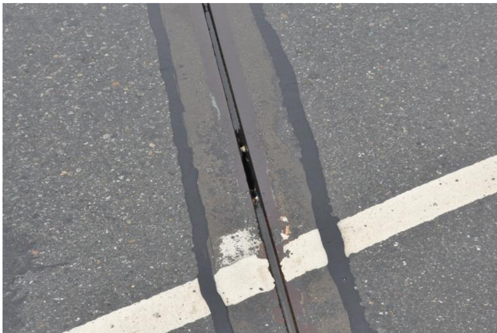
Рис. 3.1.25. Нарушение (разрыв) резинового компенсатора деформационного заполненного типа над крайней опорой №2 моста. Фото 23.09.2021г.
