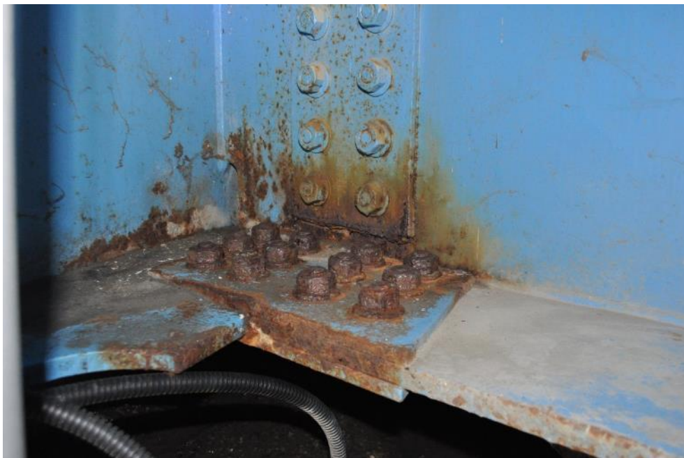
Рис. 3.2.25. Коррозия болтового соединения домкратной балки и балки Б-1 пролетного строения над крайней опорой №2. Фото 23.09.2021г.
