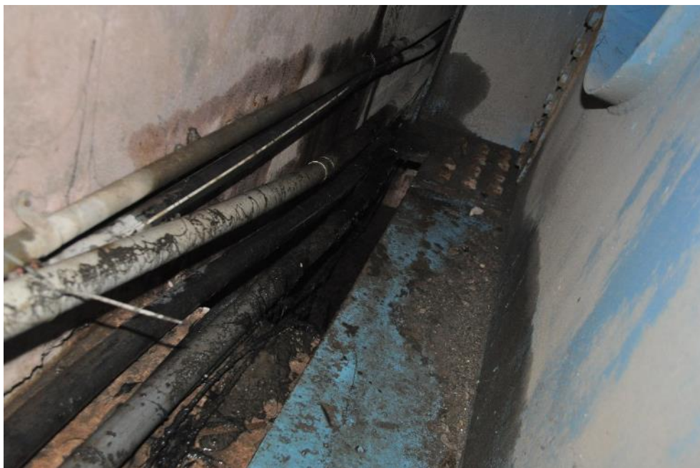
Рис. 3.2.12. Замачивание нижних поясов домкратных балок ввиду протечек через негерметичный деформационный шов над опорой №2. Фото 23.09.2021г.
