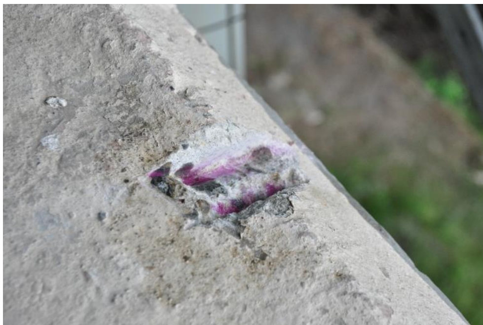
Рис. 4.2.4. Ригель крайней опоры №1, справа. Окрашивание свежевывполненного скола защитного слоя бетона в розовый цвет при нанесении пульверизацией 0,1% спиртового раствора фенолфталеина. Бетон карбонизирован на глубину, не превышающую толщину защитного слоя
