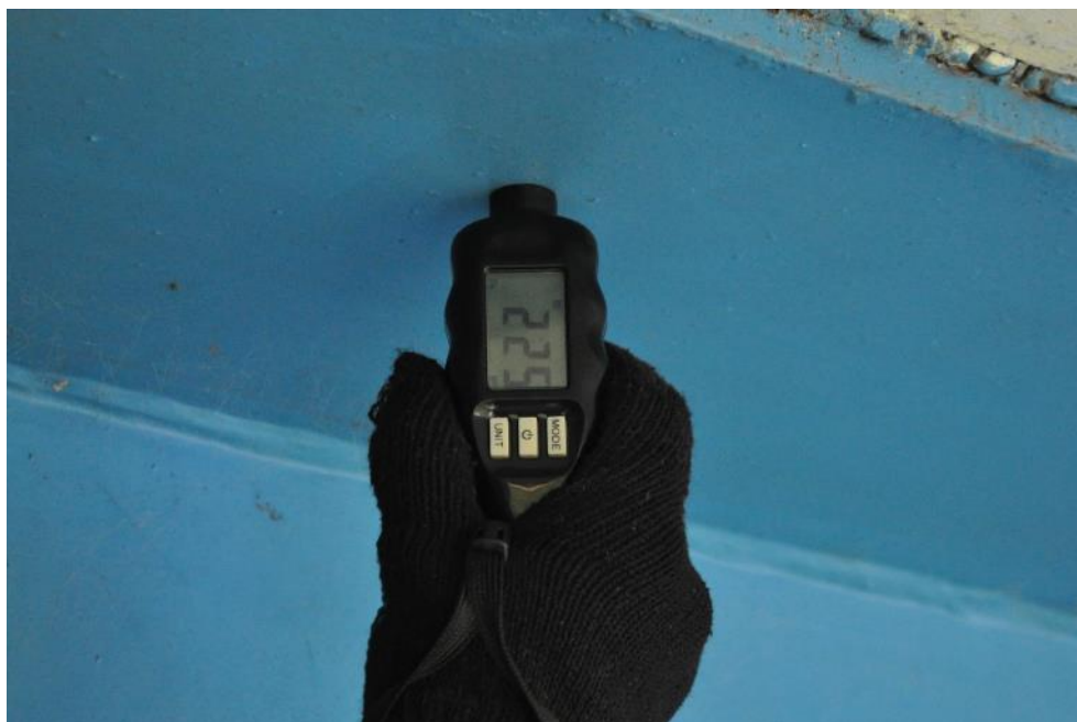
Рис. 4.4.2. Определение толщины защитного лакокрасочного покрытия верхней полки главной балки Б-3 над опорой №1 при помощи толщиномера защитных покрытий «CARSYS DPM-816»
