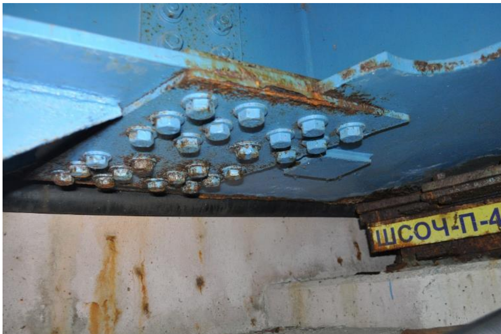
Рис. 3.2.31. Коррозия болтового соединения домкратной балки и балки Б-1 снизу на опоре №1. Фото 23.09.2021г.
