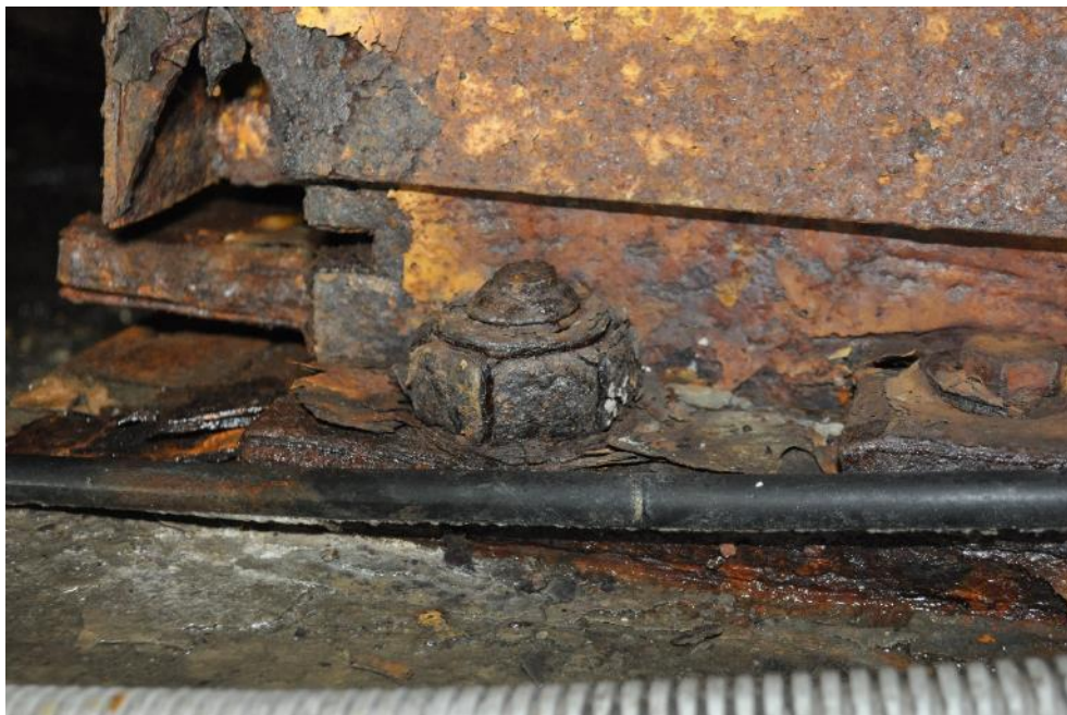
Рис. 3.3.3. Пластинчатая коррозия метизов крепления опорной части под балкой Б-3 к подферменнику (на опоре №2). Фото 23.09.2021г.
