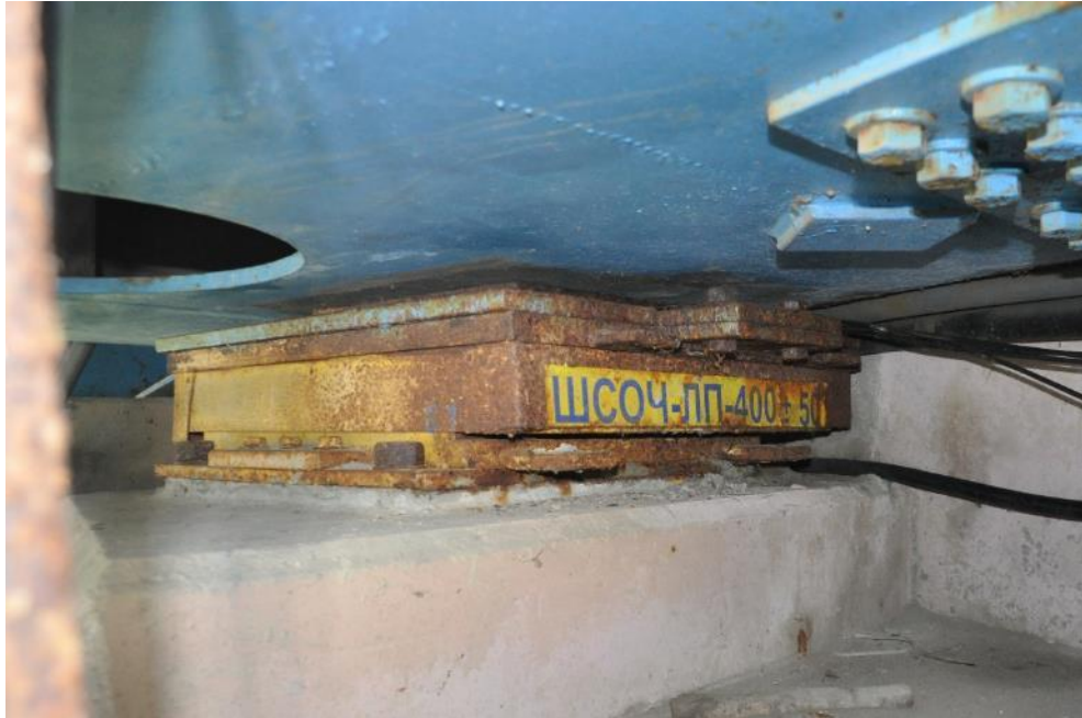
Рис. 1.11. Металлическая линейно-подвижная шарово-сегментная опорная часть под балкой Б-2 пролетного строения на крайней опоре №2 моста. Фото 23.09.2021г.
