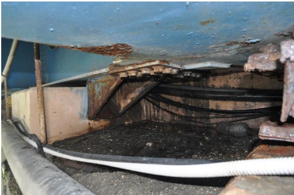
Рис. 3.2.20. Коррозия противоугонного упора между балками Б-2 и Б-3 пролетного строения над крайней опорой №2. Фото 23.09.2021г.
