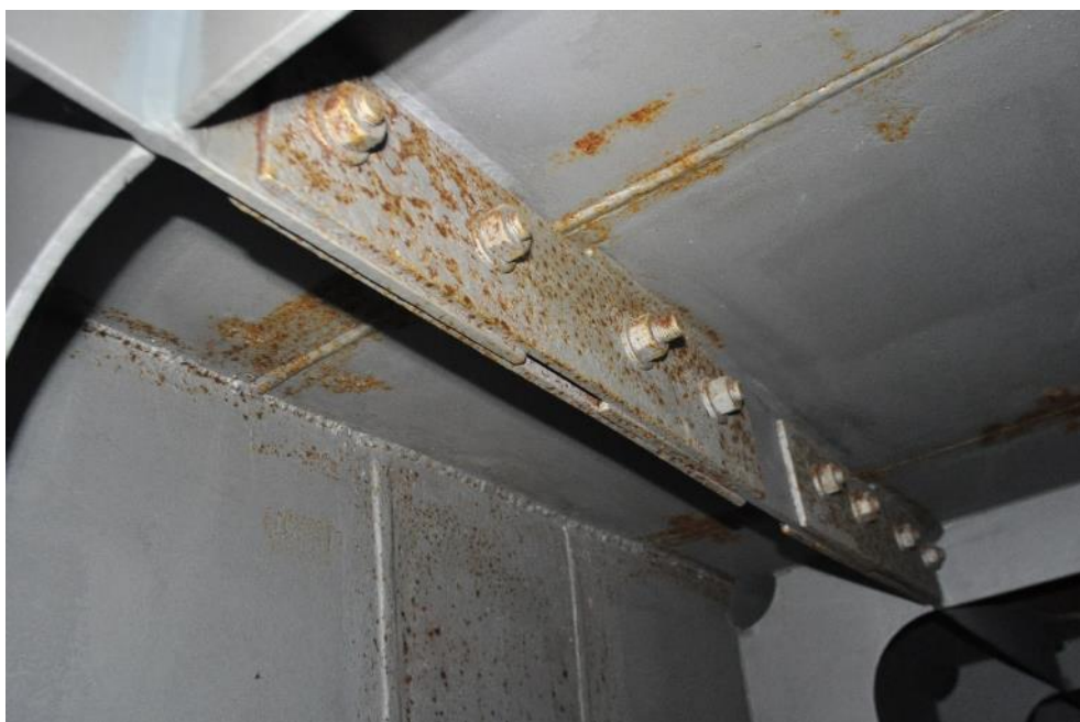
Рис. 3.2.6. Поверхностная коррозия накладок болтового соединения верхних ребер балки Б-2 пролетного строения. Фото 23.09.2021г.
