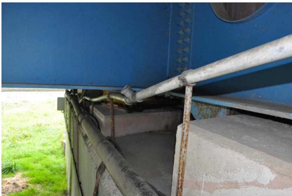
Рис. 3.1.5. Переломы в трубопроводах дренажной системы на крайней опоре №2 моста, вызывающие застой воды. Фото 23.09.2021г.
