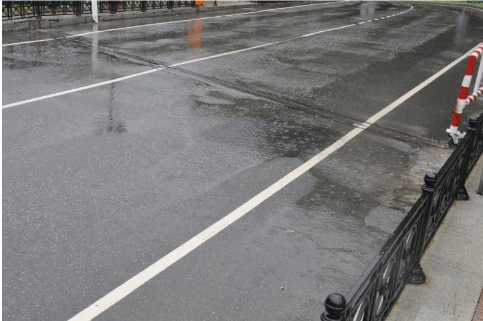
Рис. 3.1.3. Застой воды (лужа) на проезжей части моста справа, над крайней опорой №2 (в пределах полосы движения автотранспорта). Фото 23.09.2021г.
