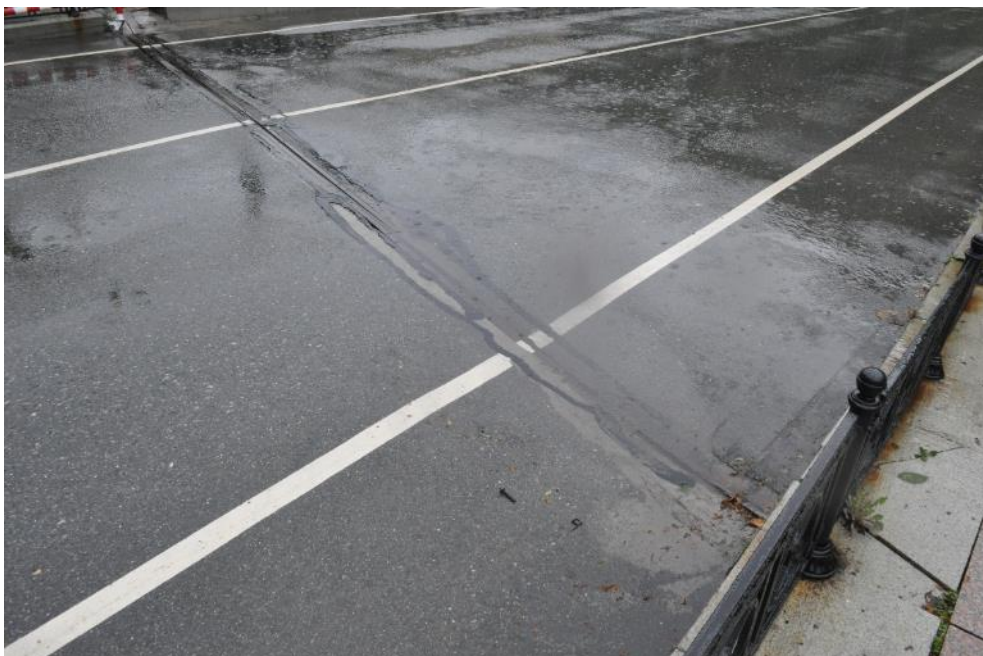
Рис. 3.1.2. Застой воды (лужа) на проезжей части моста слева, над крайней опорой №2 (в пределах полосы движения автотранспорта). Фото 23.09.2021г.
