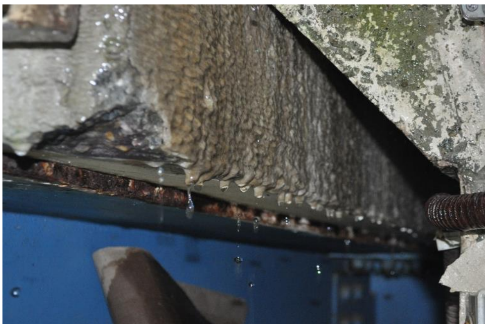
Рис. 3.2.34. Следы выщелачивания бетона, образование сталактитов на плите проезжей части моста, протечки через негерметичный деформационный шов над опорой №2. Фото 23.09.2021г.
