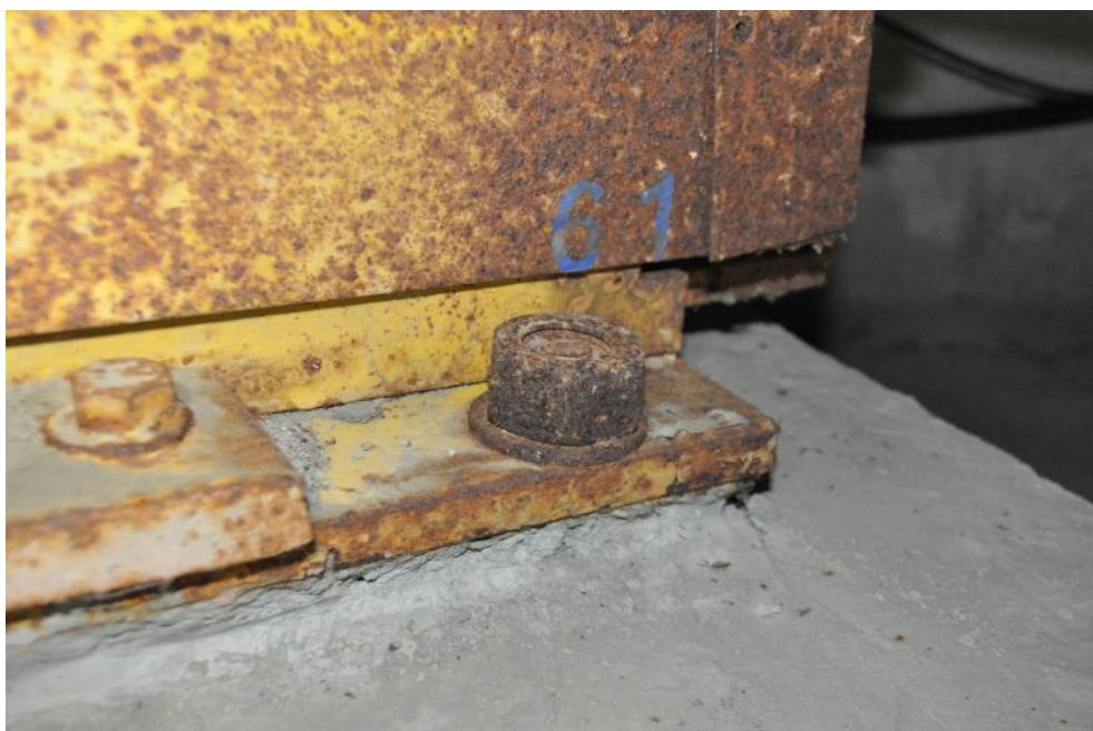
Рис. 3.3.4. Недостаточная длина анкерных шпилек крепления опорной части под балкой Б-2 к подферменнику (на опоре №2). Фото 23.09.2021г.
