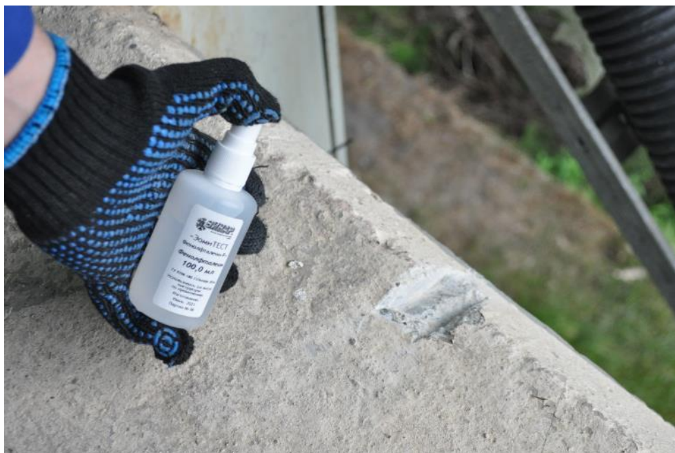
Рис. 4.2.3. Колориметрическое тестирование 0,1% спиртовым раствором фенолфталеина, наносимого пульверизацией на выполненные под углом 45° к поверхности свежевывполненные сколы защитного слоя бетона
