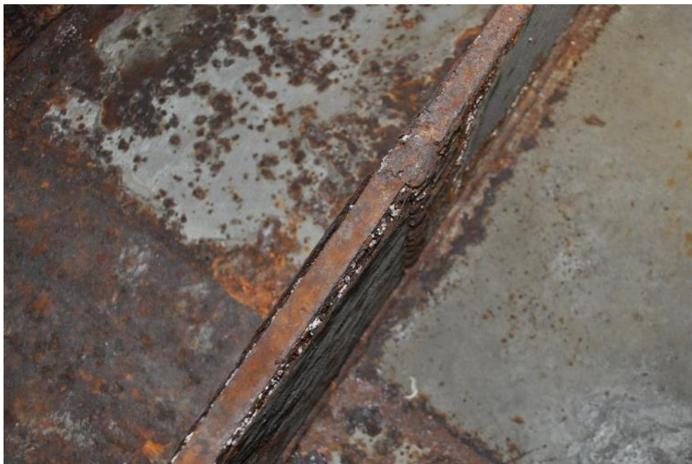
Рис. 3.2.29. Слоистая коррозия металла нижних продольных ребер балки Б-1 в местах сварных стыков Фото 23.09.2021г.
