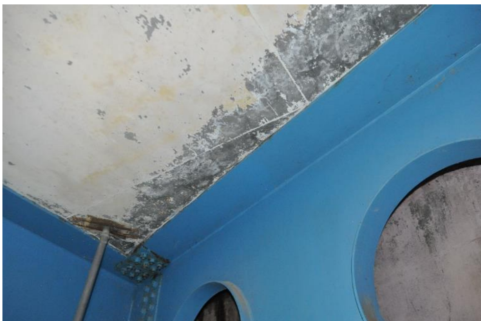
Рис. 3.2.36. Следы протечек и выщелачивания бетона, нарушение защитного покрытия плиты проезжей части над опорой №2, в зоне домкратной балки. Фото 23.09.2021г.
