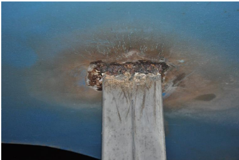
Рис. 3.2.7. Коррозия нижнего пояса балки Б-3 в месте приварки подвесных лотков коммуникаций (над опорой №1 моста). Фото 23.09.2021г.
