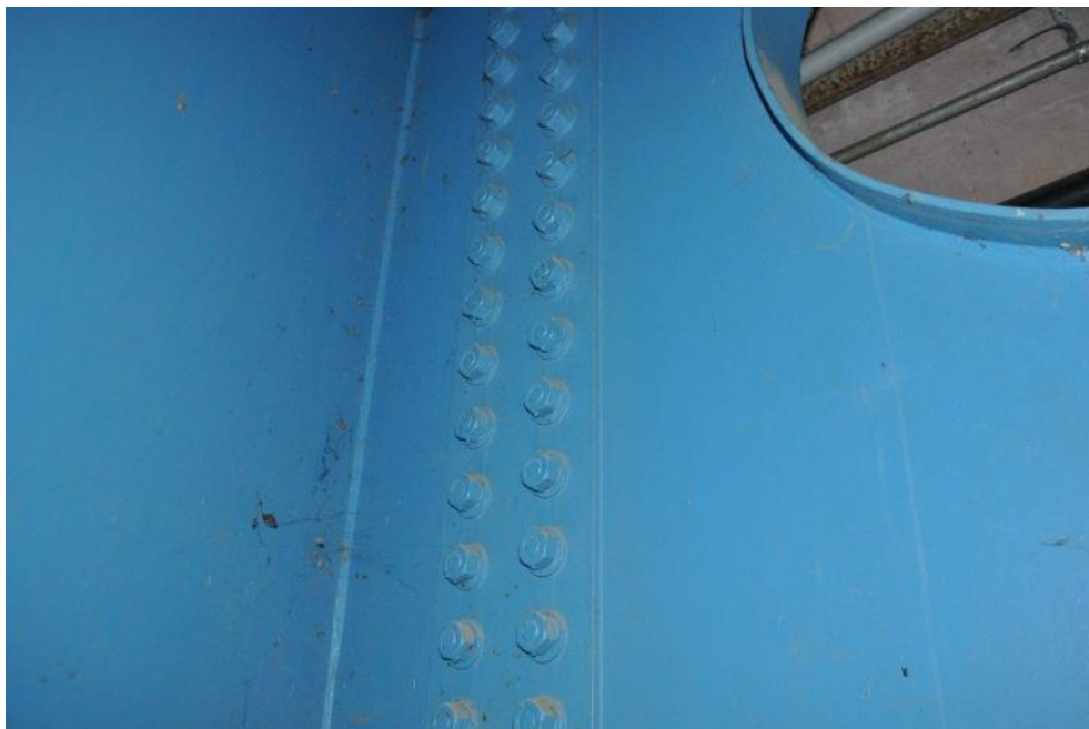
Рис. 3.2.11. Недостаточная длина высокопрочных болтов в стыке домкратной балки между главными балками Б-1 и Б-2 над крайней опорой №1 моста. Фото 23.09.2021г.
