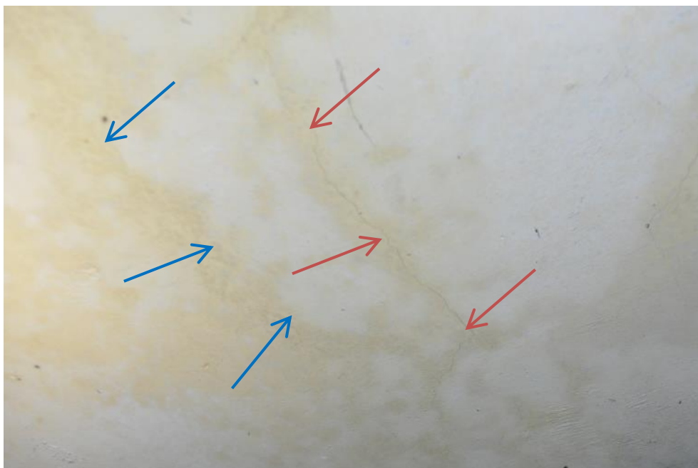
Рис. 3.2.37. Трещины в нижней поверхности плиты проезжей части между балками Б-2 и Б-3 пролетного строения над опорой №1 моста (не силовые). Фото 23.09.2021г.
