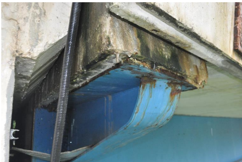
Рис. 3.2.32. Коррозия металла левой консоли над опорой №2 ввиду протечек через негерметичный деформационный шов. Фото 23.09.2021г.
