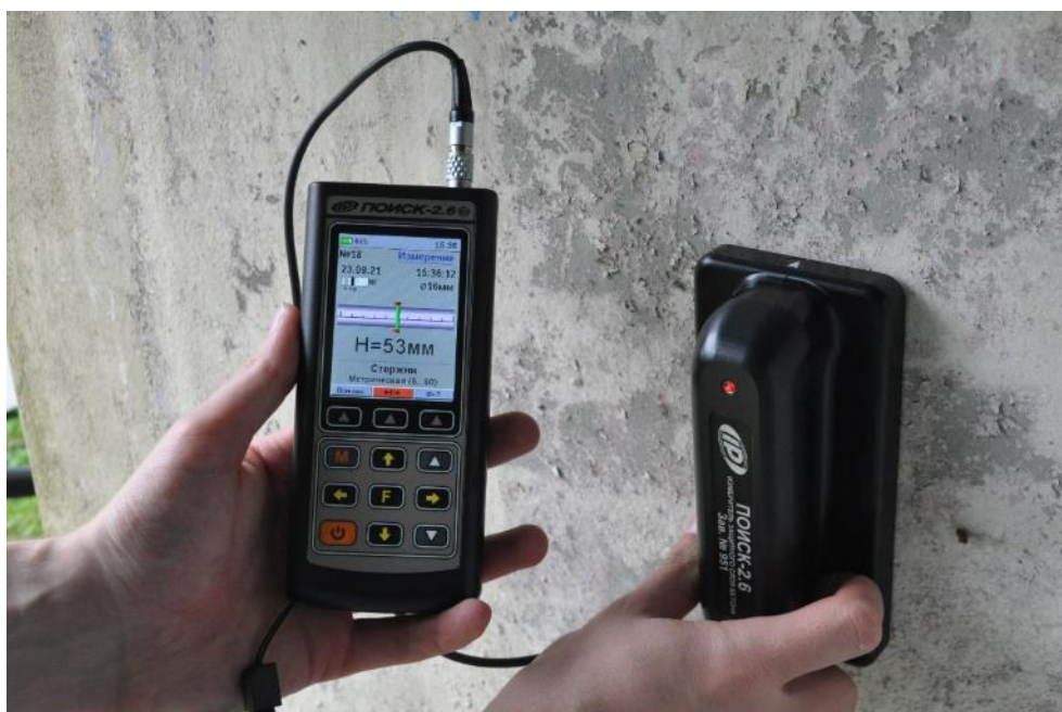
Рис. 4.2.2. Определение толщины защитного слоя бетона шкафной стенки опоры №1 ультразвуковым методом с использованием измерителя защитного слоя материалов «ПОИСК-2.6»
