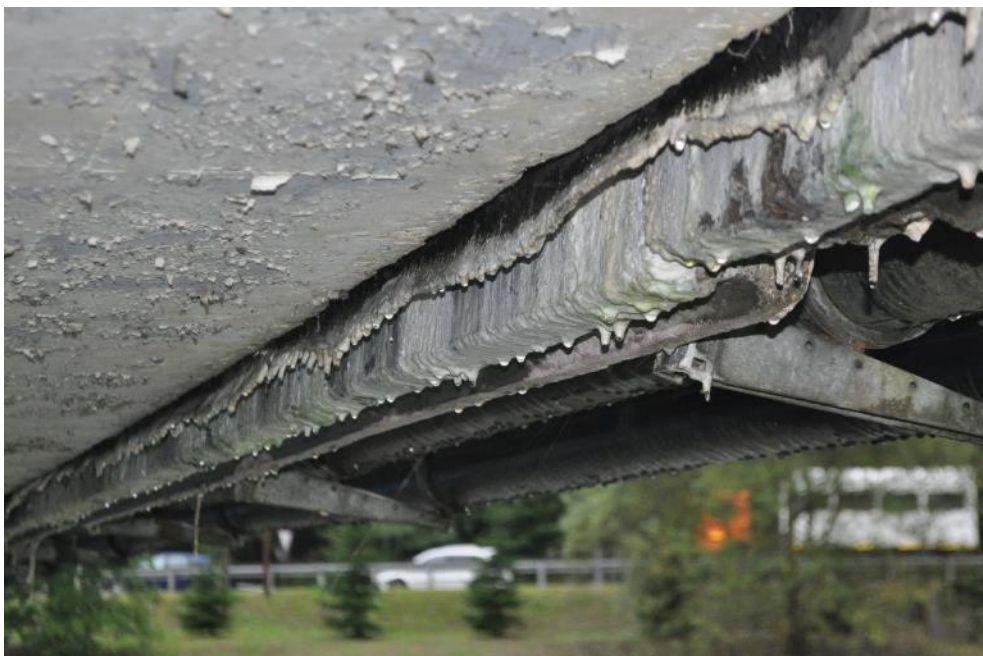
Рис. 3.1.19. Следы протечек и выщелачивания бетона с образованием сталактитов на карнизных блоках (справа, над крайней опорой №1 моста). Фото 23.09.2021г.
