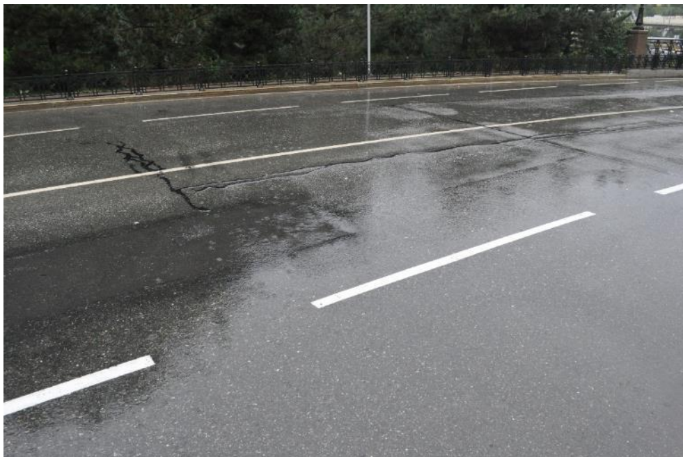
Рис. 3.6.1. Застой воды (лужа) на проезжей части подхода №1 к мосту в пределах полосы движения, справа. Фото 23.09.2021г.
