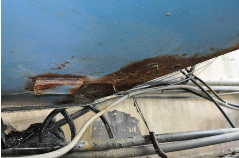
Рис. 3.2.19. Коррозия металла нижнего пояса балки Б-3 над опорой №2 в районе технологического отверстия. Фото 23.09.2021г.
