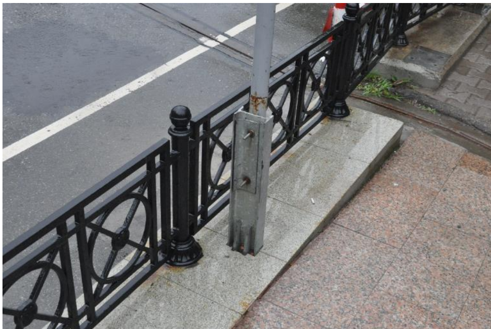
Рис. 3.6.7. Кустарное крепление знаков 2.1 «Главная дорога» и таблички 8.13 «Направление главной дороги» к стойке демонтированного барьерного ограждения. Фото 23.09.2021г.
