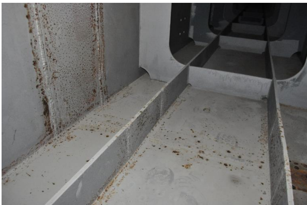
Рис. 3.2.22. Поверхностная коррозия металла в зоне сварных стыков балки Б-2 пролетного строения. Фото 23.09.2021г.
