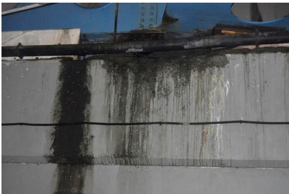
Рис. 3.4.5. Деградационное разрушение бетона с обнажением зерен крупного заполнителя ригеля опоры №2 ввиду интенсивных протечек через деформационный шов. Фото 23.09.2021г.
