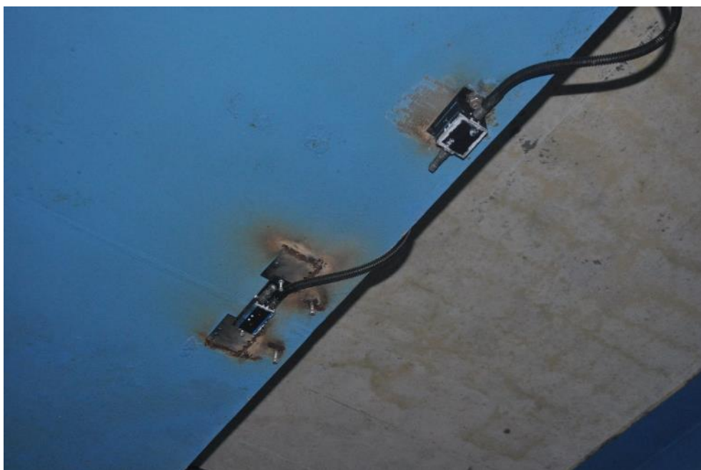
Рис. 3.2.8. Коррозия нижнего пояса балки Б-2 в месте приварки измерительного оборудования (в середине пролета моста). Фото 23.09.2021г.
