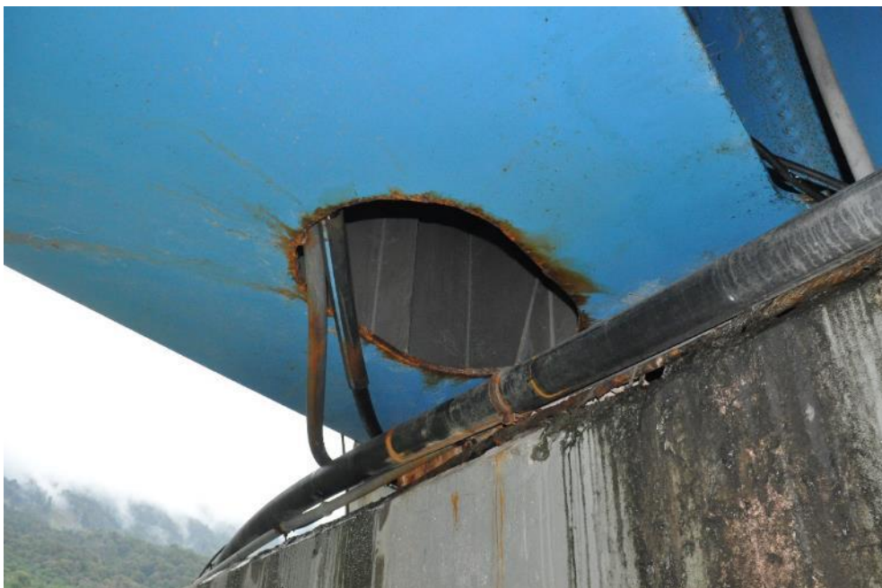
Рис. 3.2.24. Коррозия металла нижнего пояса балки Б-1 по кромке отверстия (над крайней опорой №2 моста). Фото 23.09.2021г.
