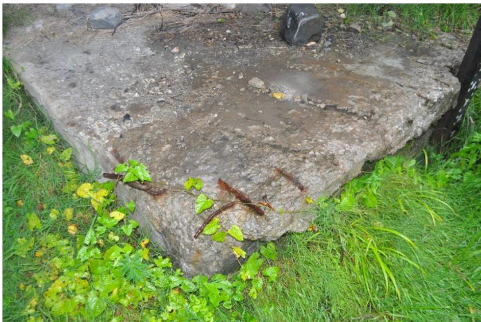
Рис. 3.4.3. Разрушение бетона ростверка опоры №1, слева, с обнажением арматурных стержней. Фото 23.09.2021г.
