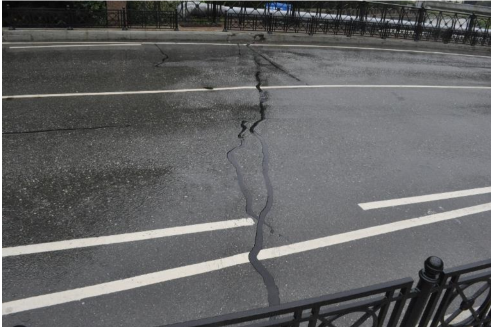
Рис. 3.1.1. Поперечные загерметизированные трещины в асфальтобетонном покрытии в зоне деформационного шва закрытого типа Thorma Joint над крайней опорой №1 мостового сооружения. Фото 23.09.2021г.
