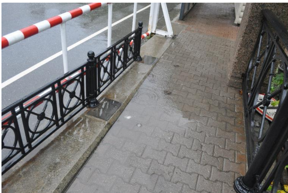
Рис. 3.1.13. Застой воды на покрытии правостороннего тротуара над крайней опорой №2 моста. Фото 23.09.2021г.
