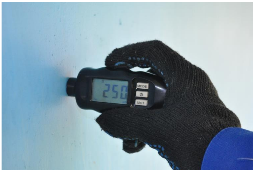
Рис. 4.4.1. Определение толщины защитного лакокрасочного покрытия стенки главной балки Б-1 над опорой №2 при помощи толщиномера защитных покрытий «CARSYS DPM-816»
